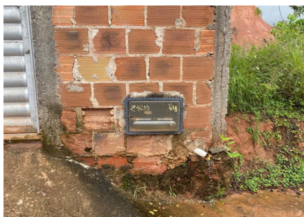
Medidor de água
