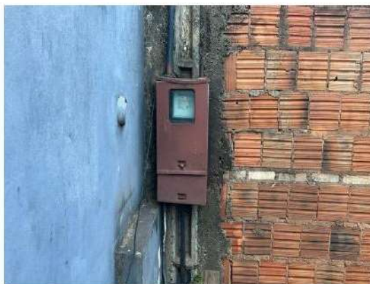
MEDIDOR DE ENERGIA ELÉTRICA
