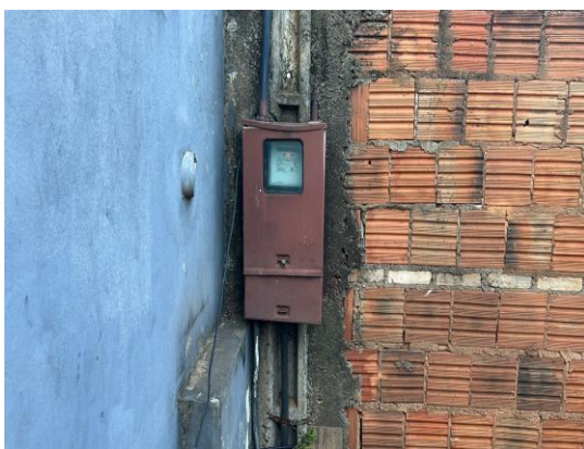
MEDIDOR DE ENERGIA ELÉTRICA
