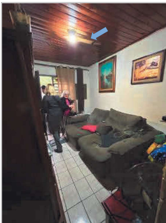
Foto 15: Sala - forro do teto em madeira com infiltração
