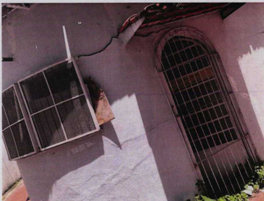
Aspectos do estado da construção – trincas e rachaduras que oferecem riscos de segurança
