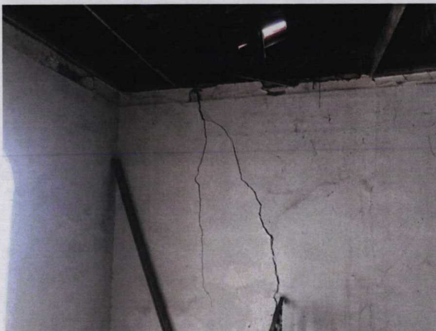
Estado do teto e paredes
