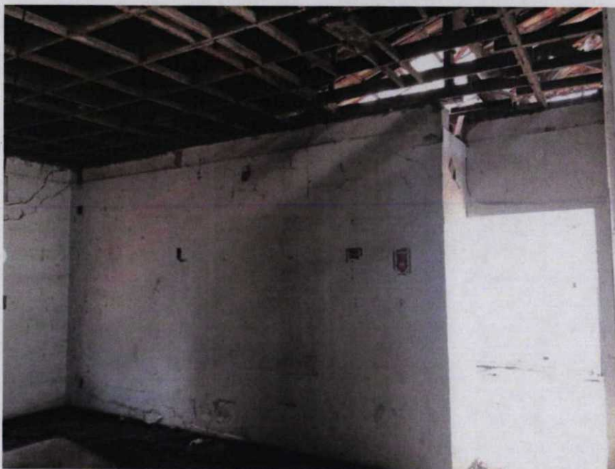
Estado do teto e paredes
