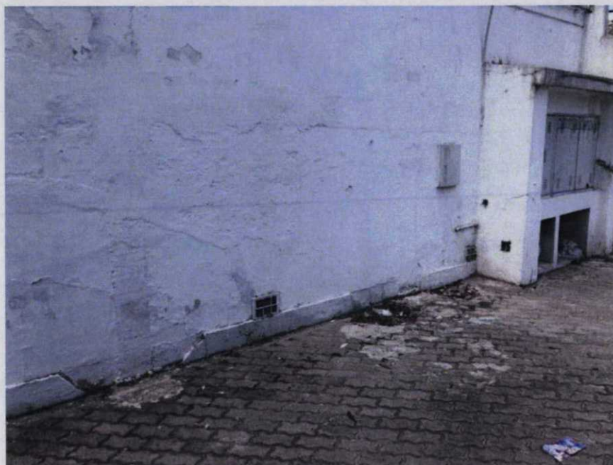
Aspectos do estado da construção – trincas e rachaduras
