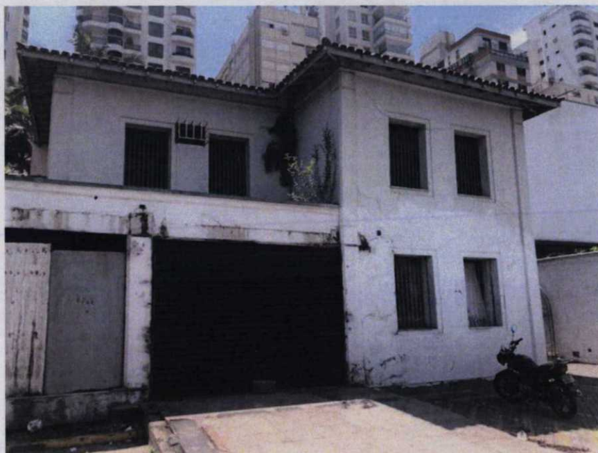
Fachada frontal da edificação – esquadrias removidas e danos em seus diversos componentes
