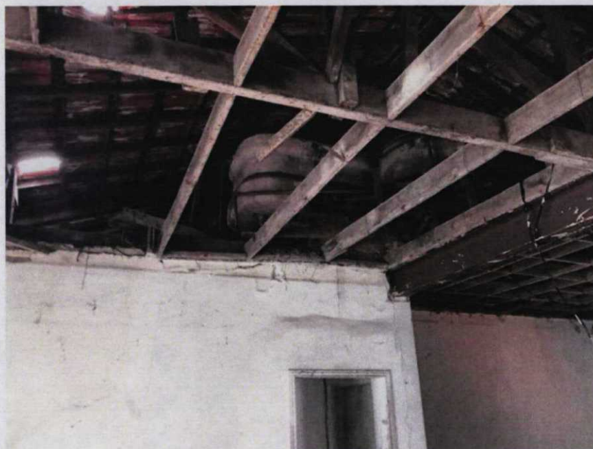
Estado do teto e paredes
