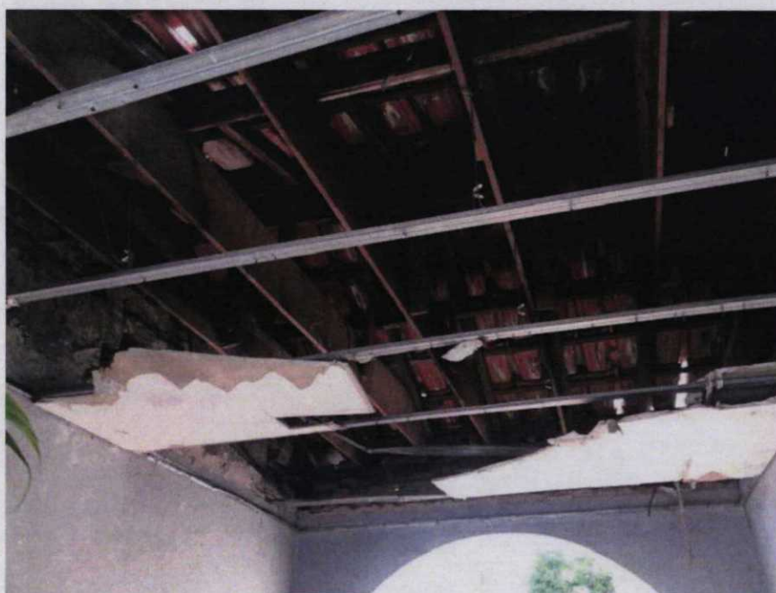
Aspectos do estado da construção – infiltrações e estado do forro
