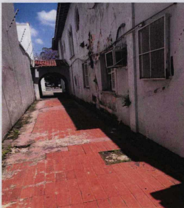
Vista lateral da construção- afundamento do piso
