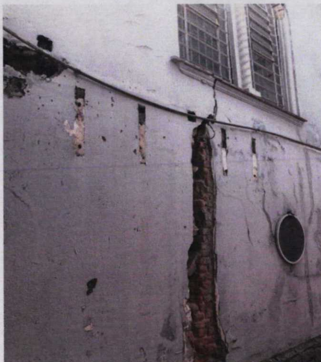
Aspectos do estado da construção – trincas e rachaduras que oferecem riscos de segurança
