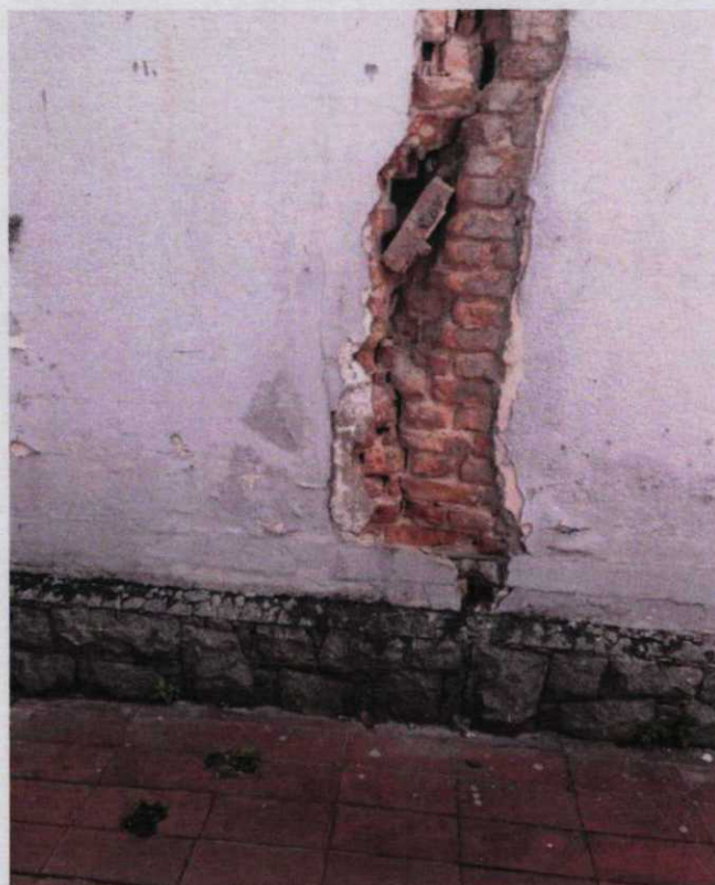
Aspectos do estado da construção – trincas e rachaduras que oferecem riscos de segurança
