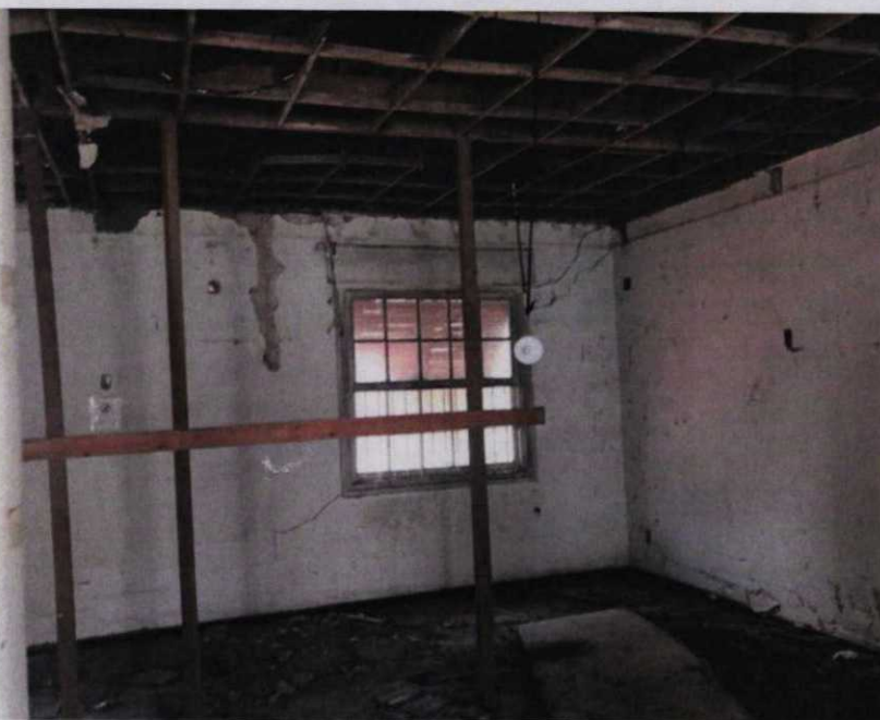
Estado do teto e paredes
