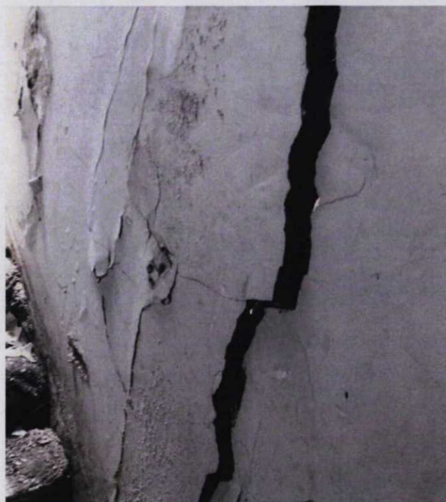
Estado da parede - rachadura
