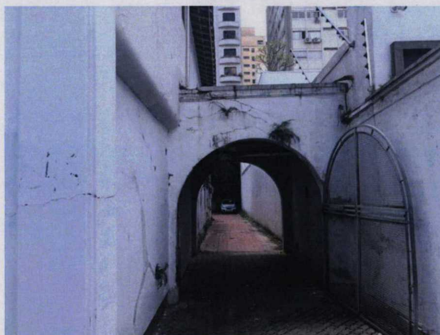
Aspectos do estado da construção – trincas e rachaduras
