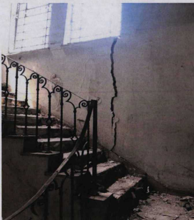
Rachadura na parede da escada
