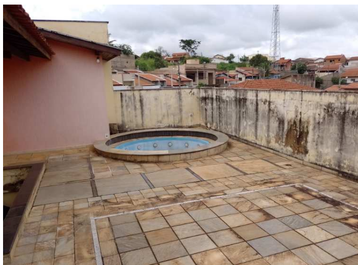
Quintal – piscina em desuso(danificada).
