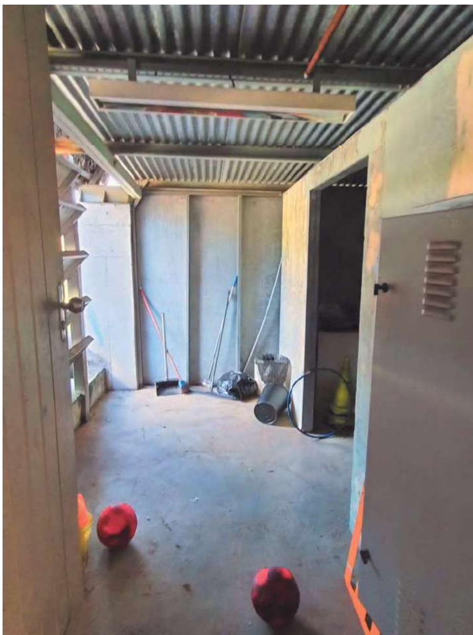
Quadra de esportes – estrutura e conservação
