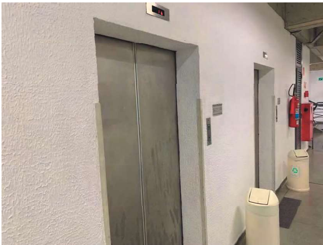
Elevadores Bloco Branco
