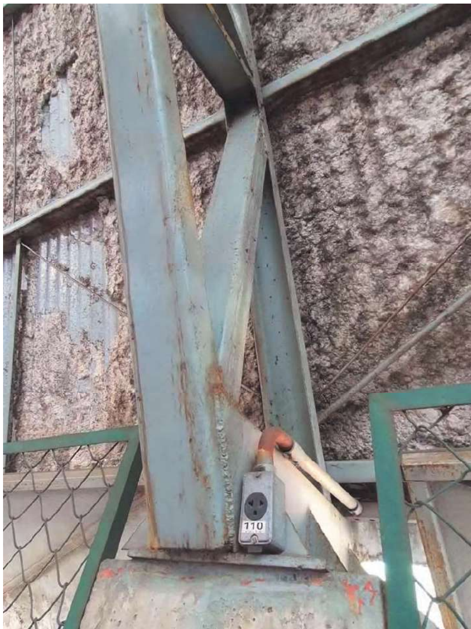
Quadra de esportes – estrutura e conservação
