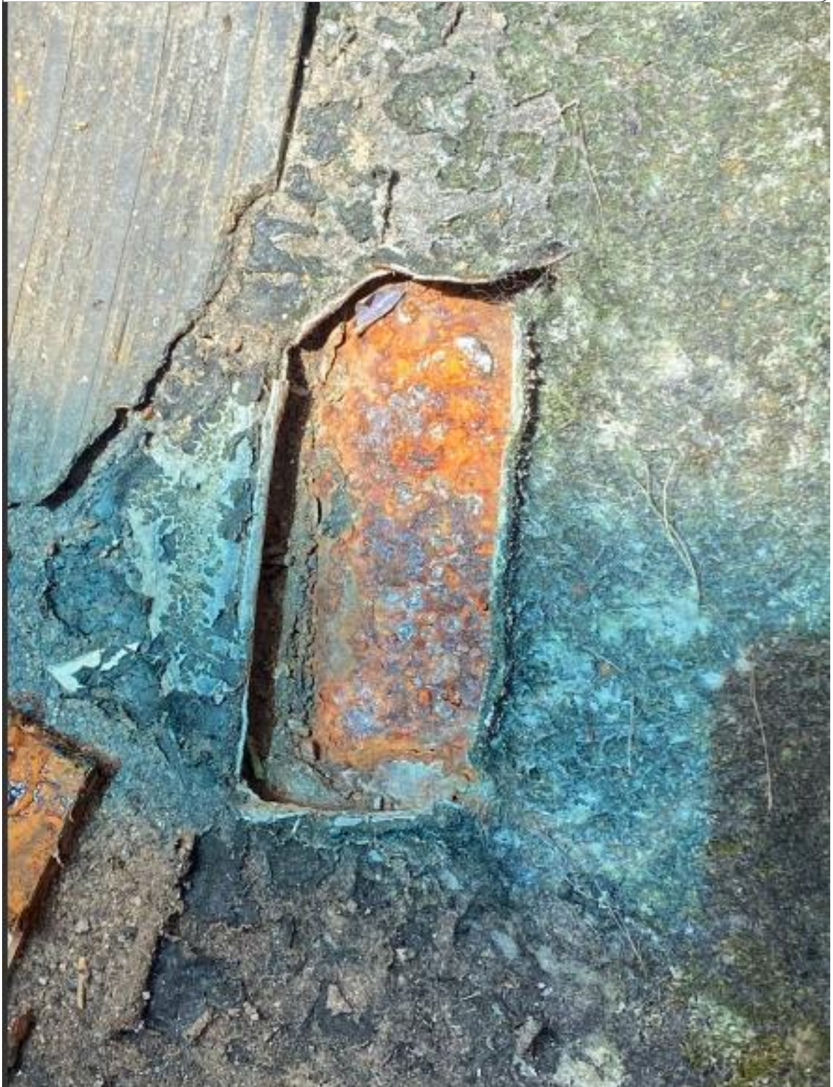
Figura 4: Suporte de gravação da numeração do chassi completamente oxidado.
