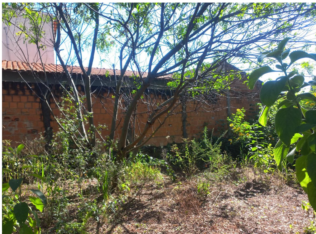
Foto 17: Muro à direita de quem de dentro do lote olha para a rua
