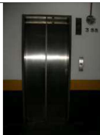
Foto 12 – Elevador da garagem do subsolo.
