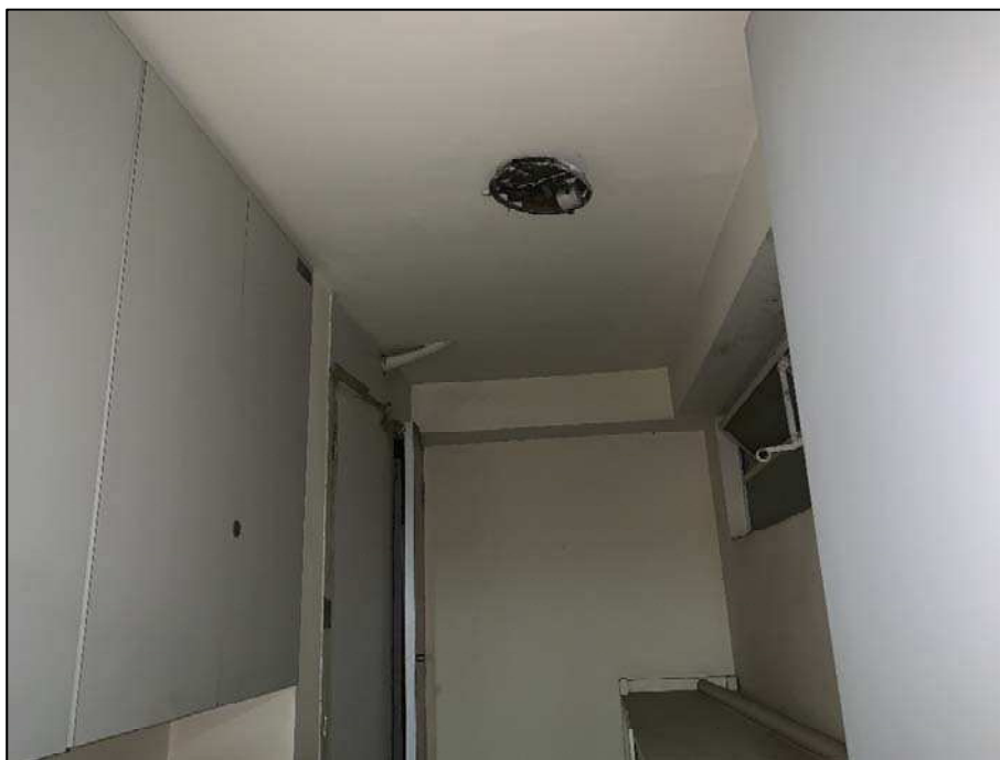
Foto 13. Detalhe do teto do arquivo 1 do imóvel avaliando.
