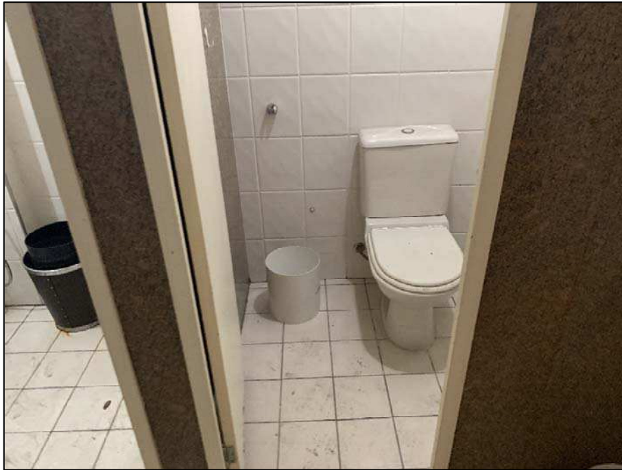
Foto 05. Detalhe da louça sanitária do banheiro da sala de reunião.
