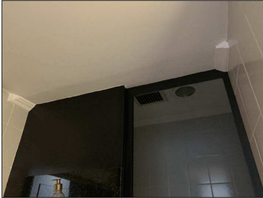
Foto 29. Detalhe do teto do banheiro social do imóvel avaliando.
