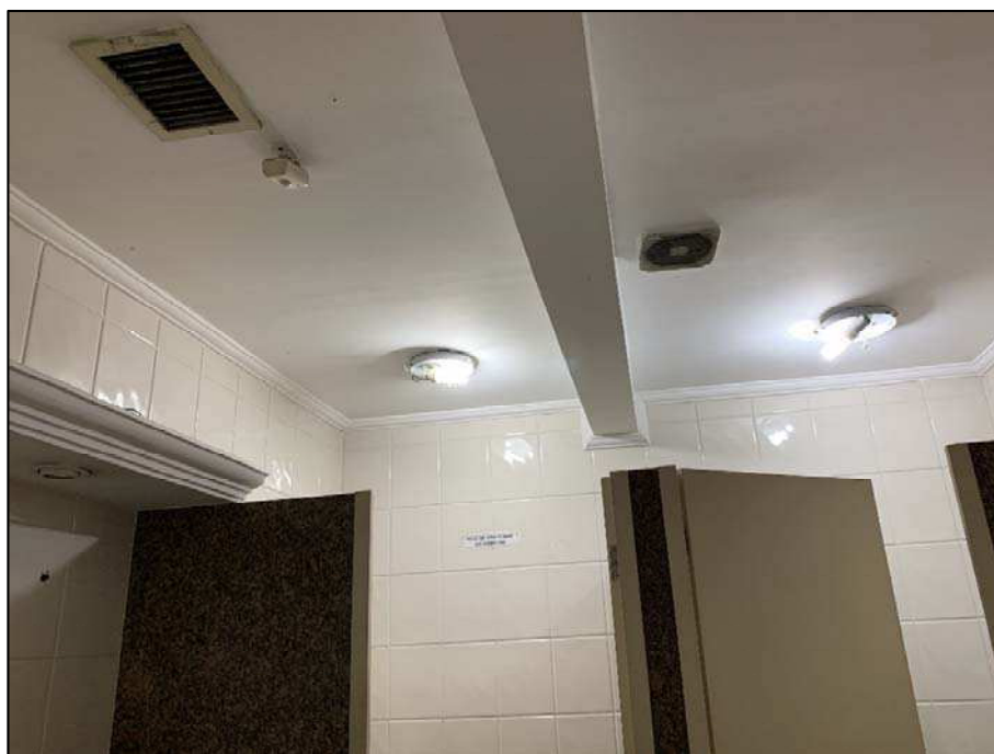
Foto 16. Detalhe do teto do banheiro masculino do imóvel avaliando.
