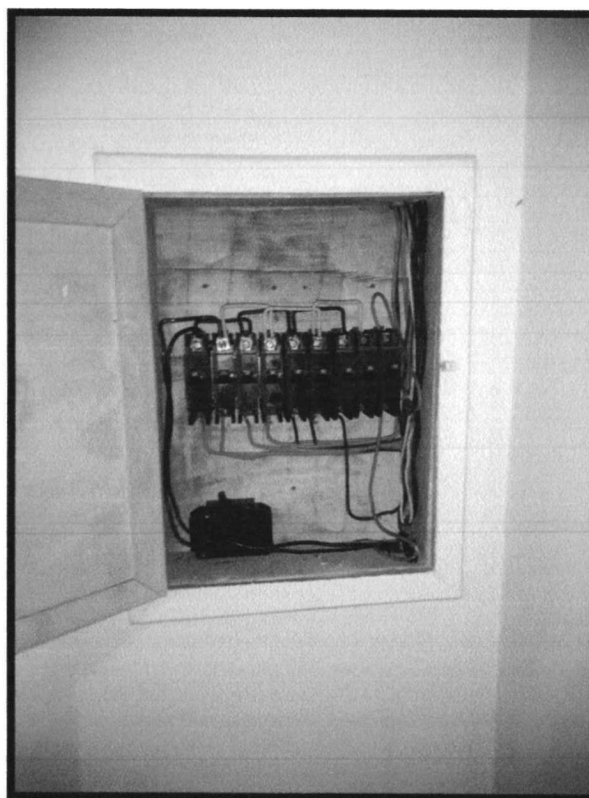
Figura 67: Detalhe do quadro elétrico em madeira Fonte: Autoria própria (2022)
