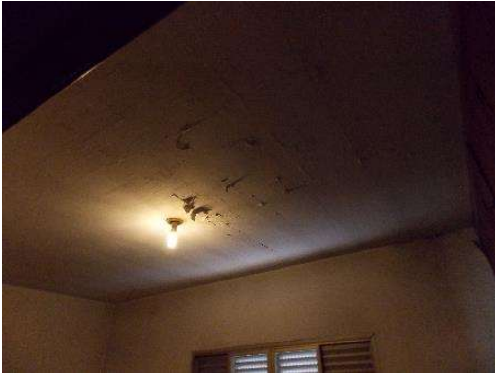
Foto nº 23 – Teto dormitório 03 com infiltrações.
