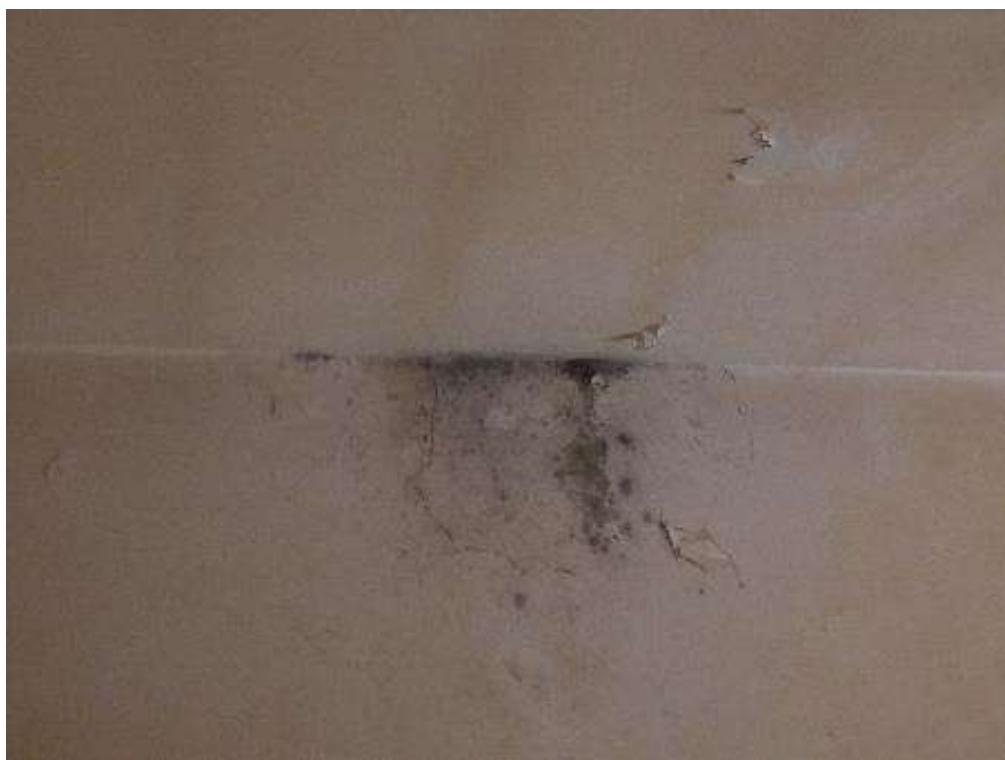
Foto nº 19 – Infiltração teto dormitório 01
