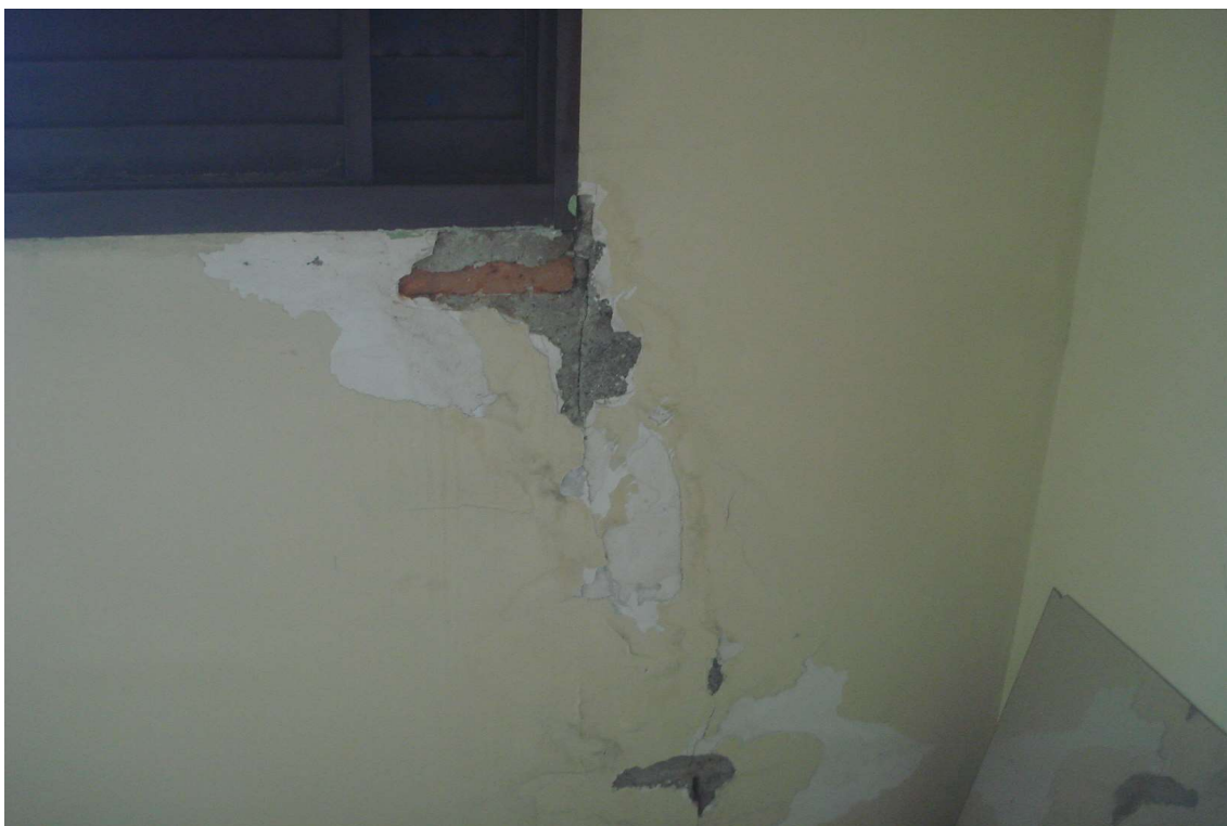
FOTO N° 12 – Vista da deterioração na parede no primeiro dormitório.
