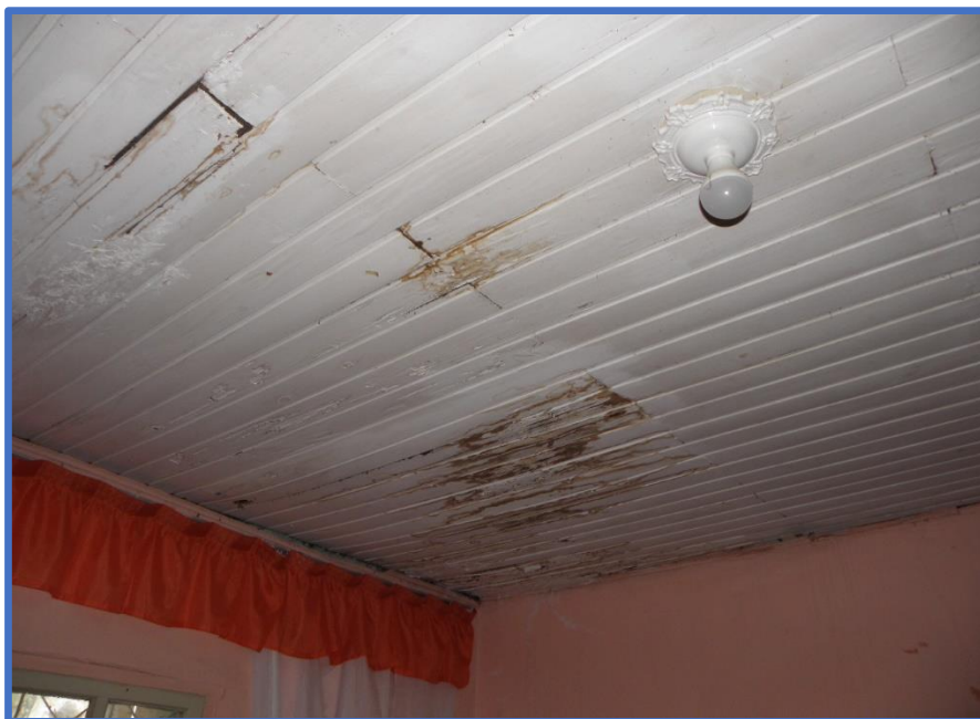
Foto: Vista do teto da sala, térreo, com infiltrações.
