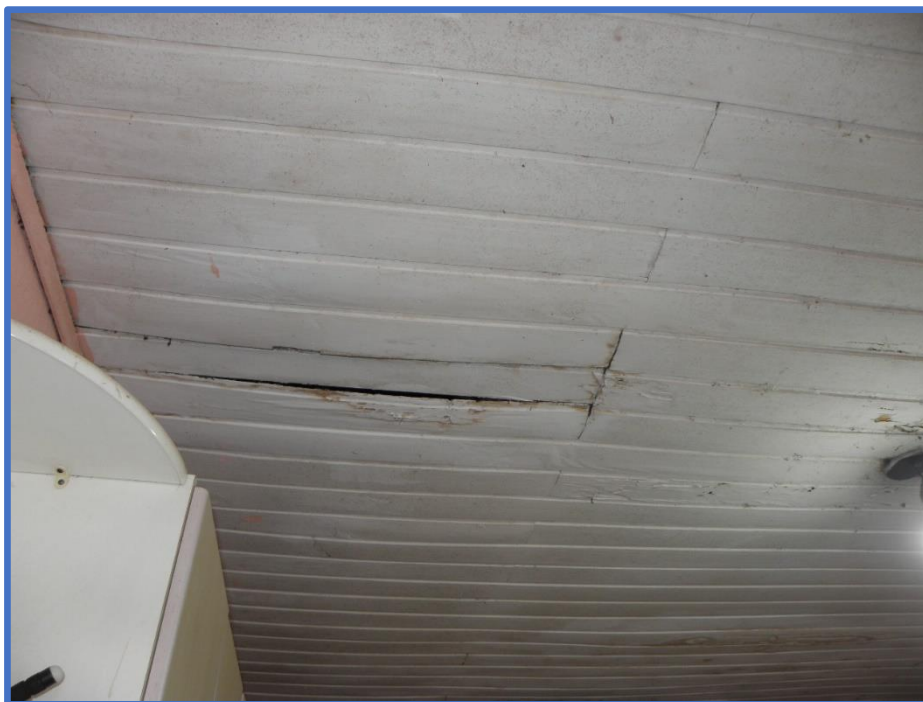
Foto: Vista do teto da cozinha, térreo, com infiltrações.
