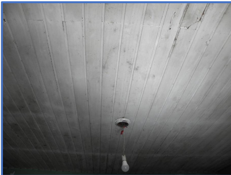
Foto: Vista do teto do quarto, térreo, com infiltrações.
