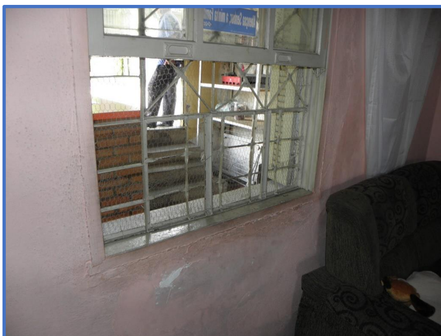
Foto: Vista de parede da sala, térreo, com infiltrações.;
