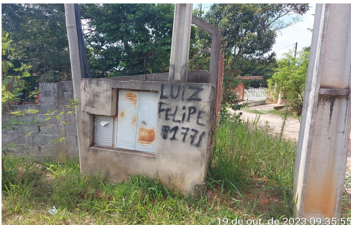
Foto 04 – Caixa de força na Viela e Rua Luiz Felipe, nº 1771
