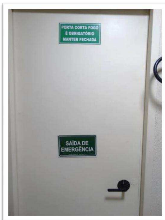
Foto nº 34 - Vista da porta corta fogo no hall de elevadores do 4º pavimento do bloco 17.
