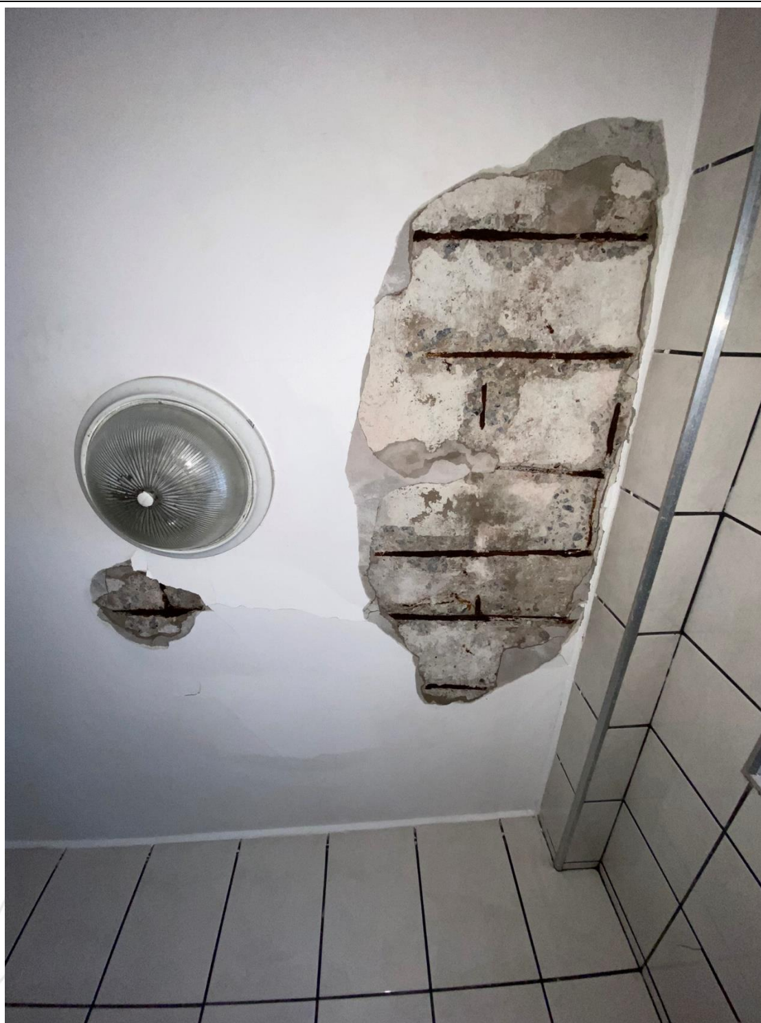
FOTOGRAFIA 21 – DETALHE DE DEGRADAÇÃO ACENTUADA EM LAJE DO BANHEIRO.
