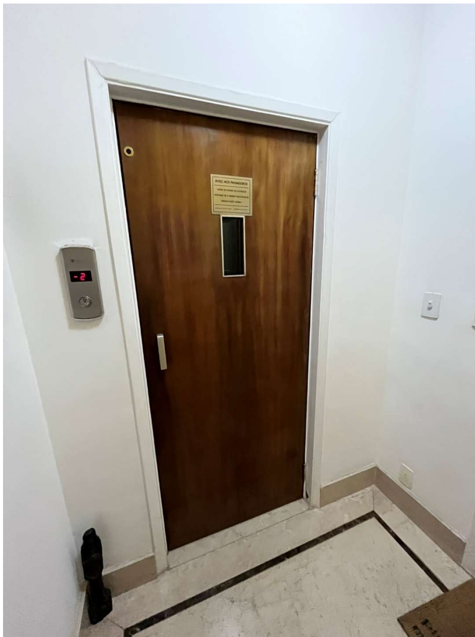
Figura 11: elevador de serviço
