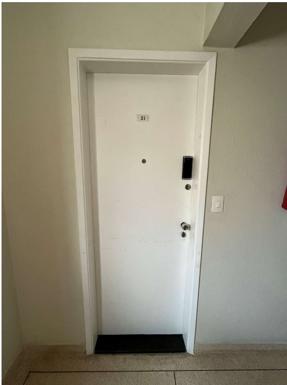
Figura 12: porta da entrada de serviço do apartamento 21 - imóvel avaliando
