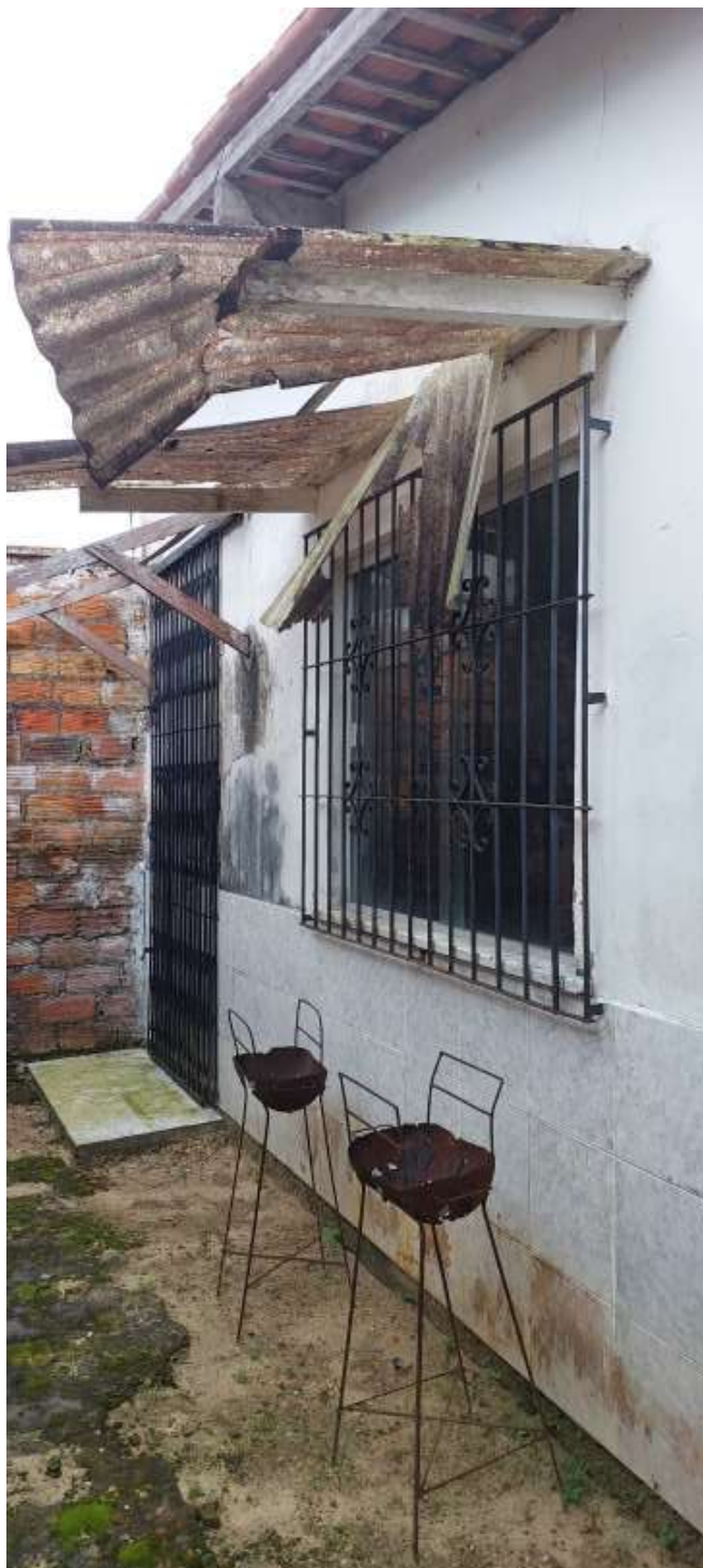
Vista dos fundos do imóvel – telhas destruídas
