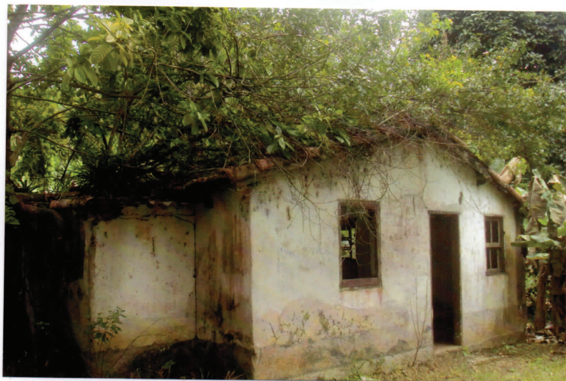
Foto nº 10 – Outra vista do interior do Sítio São Nicolau, observando-se a outra casa existente, em alvenaria de bloco rebocada, com algumas esquadrias e cobertura com telha cerâmica. Notar estado precário, havendo ataque de cupim e necessitando de ampla reforma. As casas são acessadas pela estrada interna, distando cerca de 100,00 metros da estrada principal após a passagem pela "pinguela."
