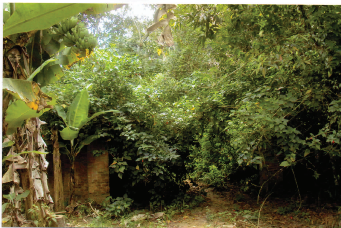
Foto nº 5 – Vista de muro em tijolo aparente e que suportava antigo portão por onde se tem acesso à estrada interna após a ultrapassagem do ribeirão através da “pinguela”. Observar que não existe conservação, predominando a vegetação regenerada já em estágio secundário.
