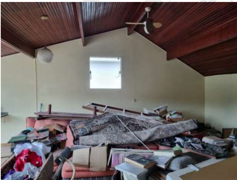
Foto 26 – Vista geral do mezanino. Constatação da falta de manutenção no local.
