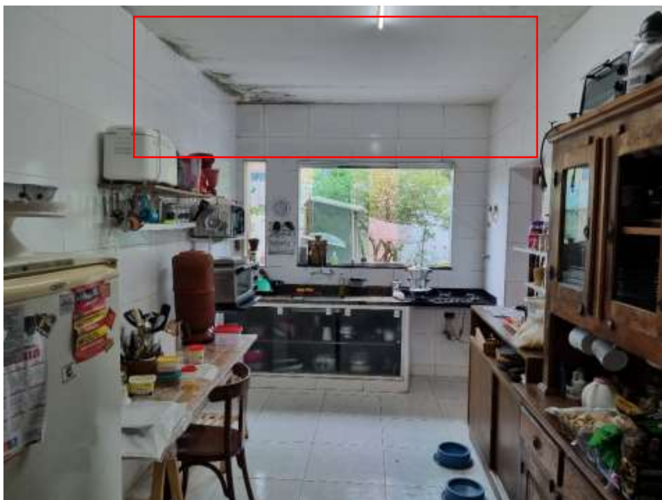
Foto 13 – Vista geral da cozinha. Constatação de exemplo de infiltração em teto, conforme marcação em vermelho.
