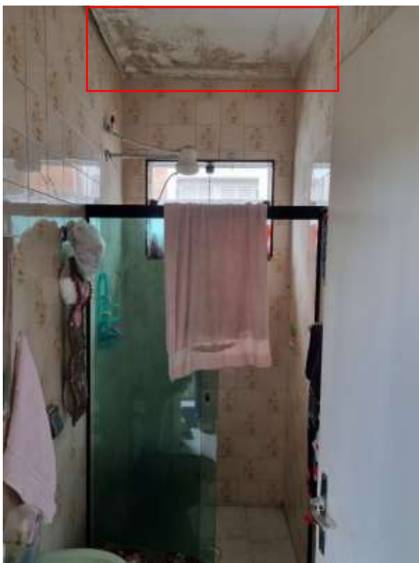
Foto 17 – Vista geral do banheiro de dependência de funcionários. Constatação de exemplo de infiltração ativa, conforme marcação em vermelho.
