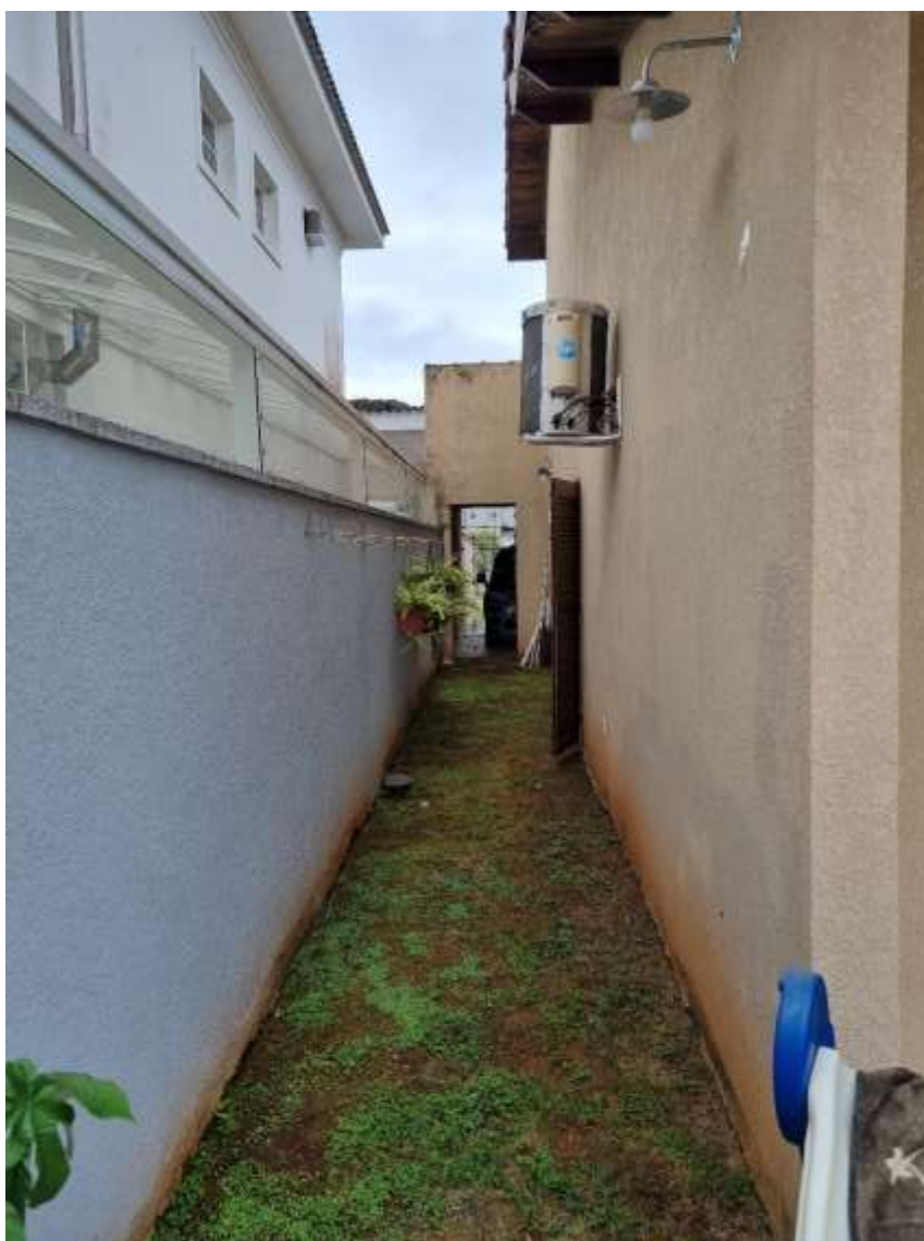
Foto 39 – Vista geral do corredor lateral direito da casa. Constatação da falta de manutenção das fachadas e muros.
