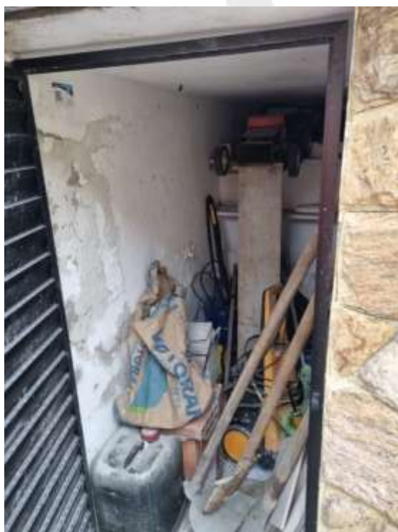
Foto 38 – Vista geral do quartinho, localizado nos fundos da casa. Constatação da falta de manutenção no local.
