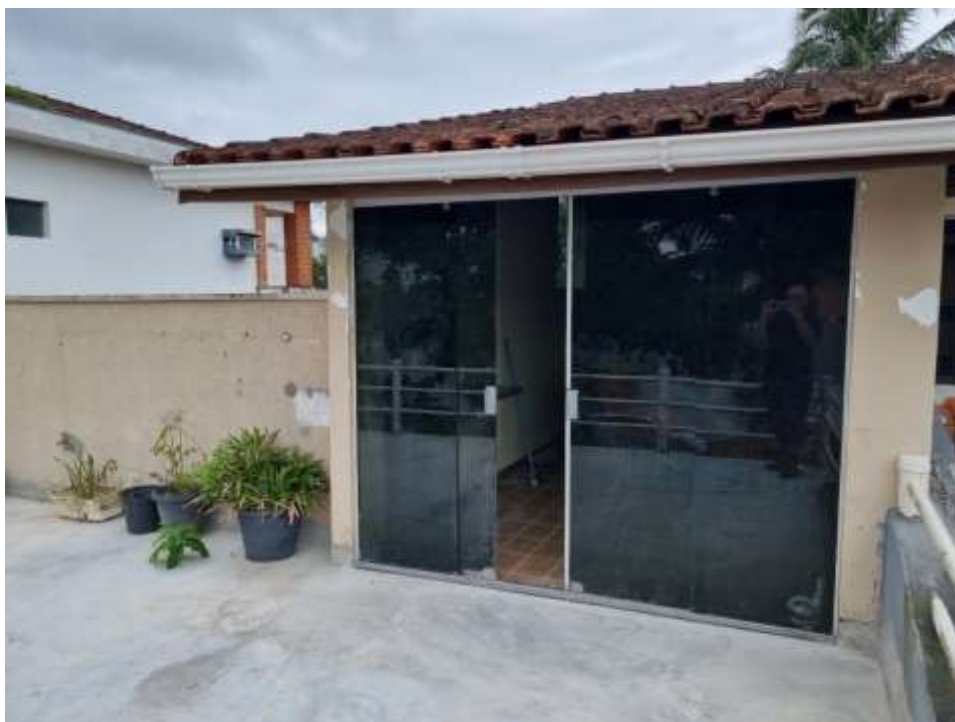
Foto 29 – Vista geral da varanda, localizada no 1º pavimento, vista de outro ângulo. Constatação da falta de manutenção no local.
