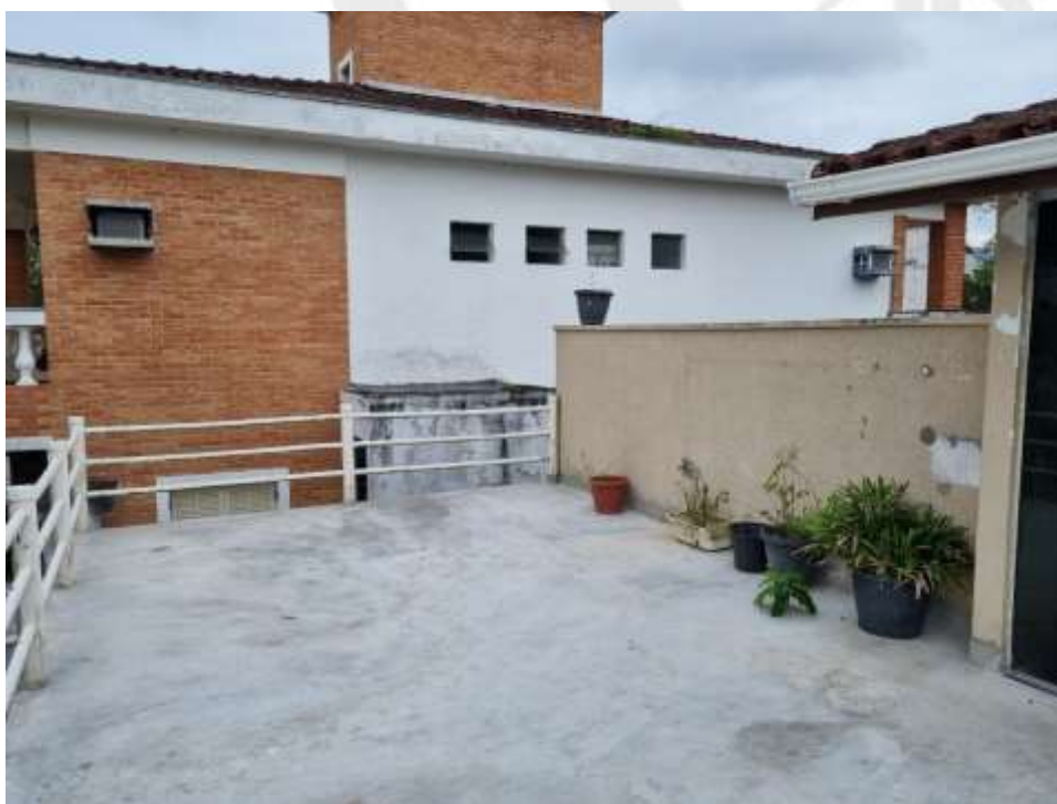
Foto 28 – Vista geral da varanda, localizada no 1º pavimento. Constatação da falta de manutenção no local.
