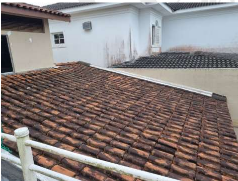
Foto 30 – Vista geral do telhado. Constatação de falta de manutenção.
