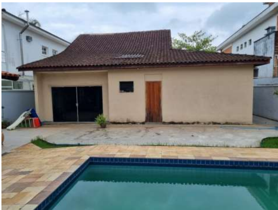
Foto 37 – Vista geral da fachada dos fundos do imóvel. Constatação da falta de manutenção nas fachadas e telhado.
