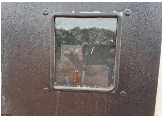
Medidor de energia
