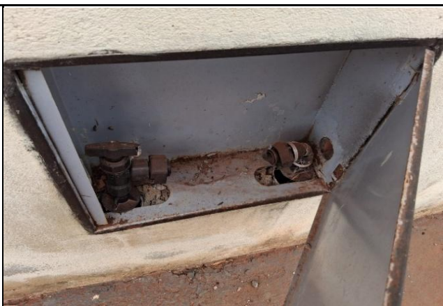
Entrada de água
