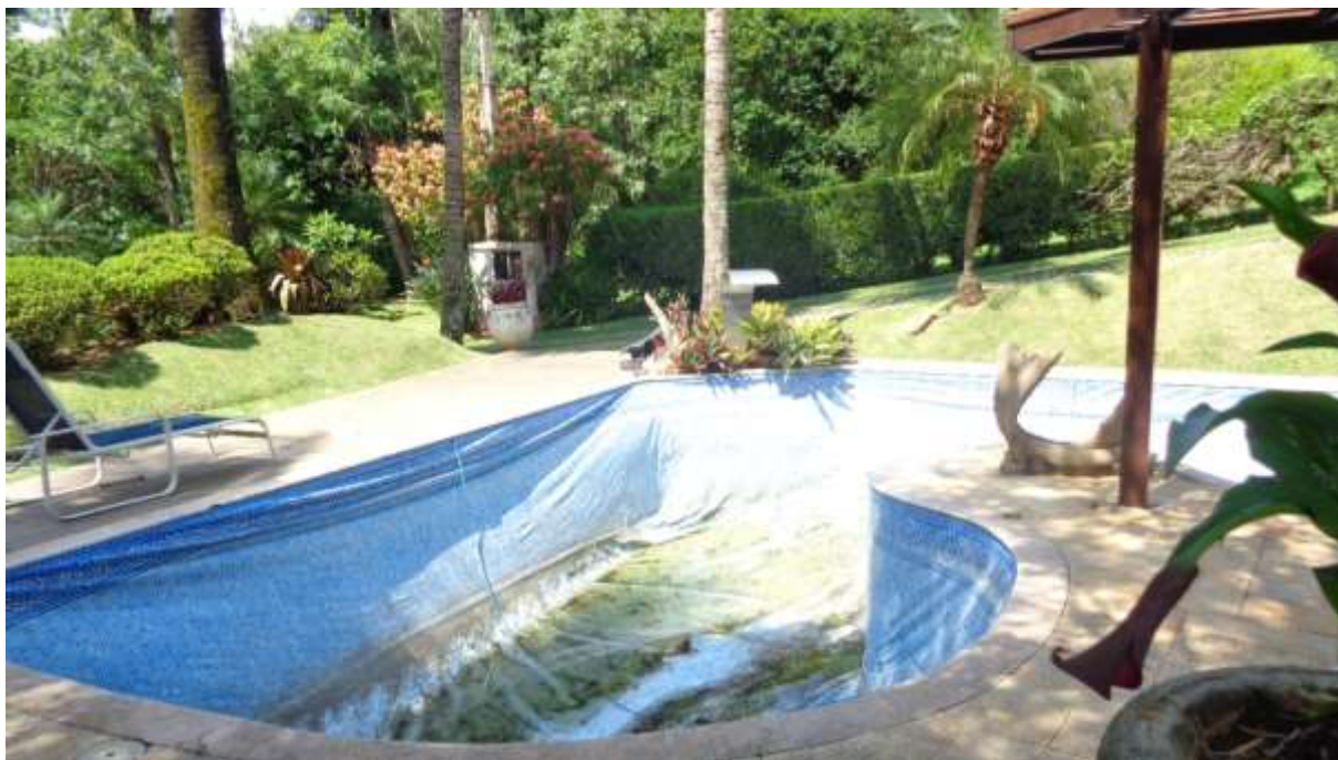
FOTO N.º 09- Vista da piscina, necessitando de troca do vinil.
