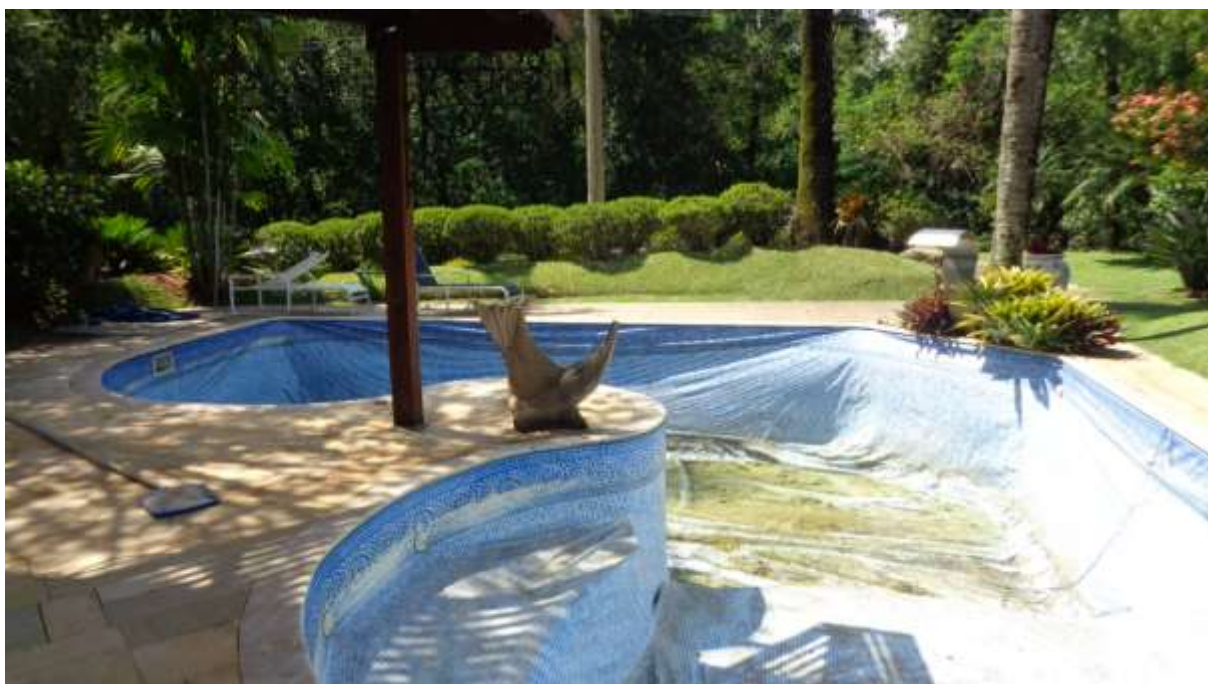
FOTO N.º 10- Tomada da piscina, necessitando de troca do vinil.
