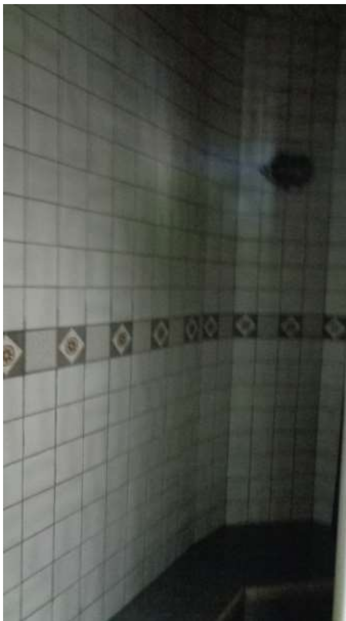
FOTO N.º 24- Tomada interna da sauna no pavimento térreo.
