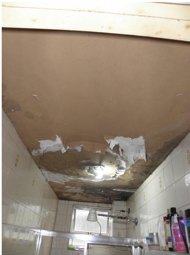
Foto: Teto do banheiro, descascado e com manchas de umidade.
