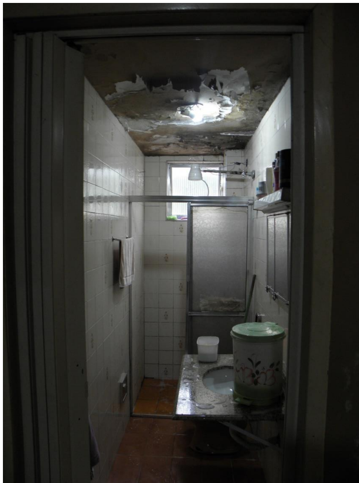
Foto: Banheiro, com teto descascado e marcas de umidade no teto.
