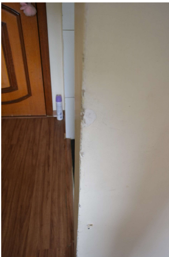
FOTO 40: BATIDAS E DESCASCADOS NA QUINA DA PAREDE DA SALA.
