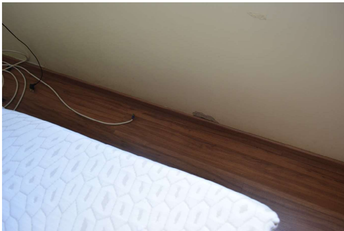
FOTO 59: DESCASCADO NO RODAPÉ, EMBAIXO DA JANELA DO DORMITÓRIO 1.
