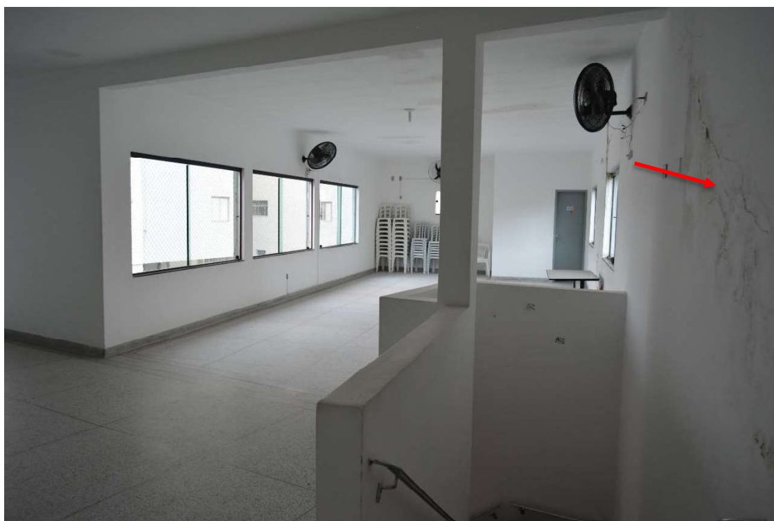
FOTO 26: VISTA DO SALÃO DE FESTAS, COM PONTOS DE INFILTRAÇÃO NA ALVENARIA À DIREITA.
