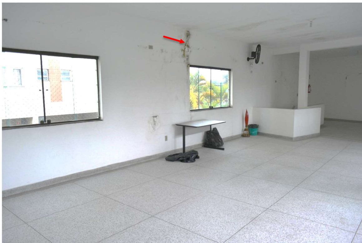
FOTO 28: VISTA OPOSTA DO SALÃO, MAIS PONTOS DE INFILTRAÇÃO.
