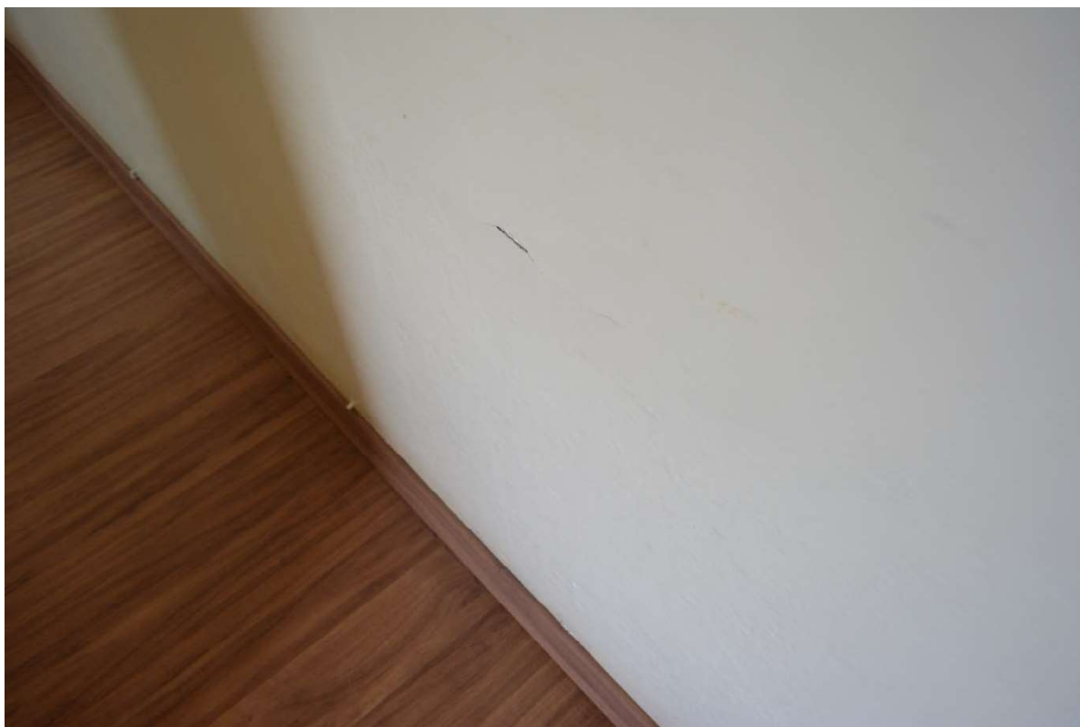
FOTO 62: DESTACAMENTO DO ACABAMENTO NA ALVENARIA DO DORMITÓRIO 1.
