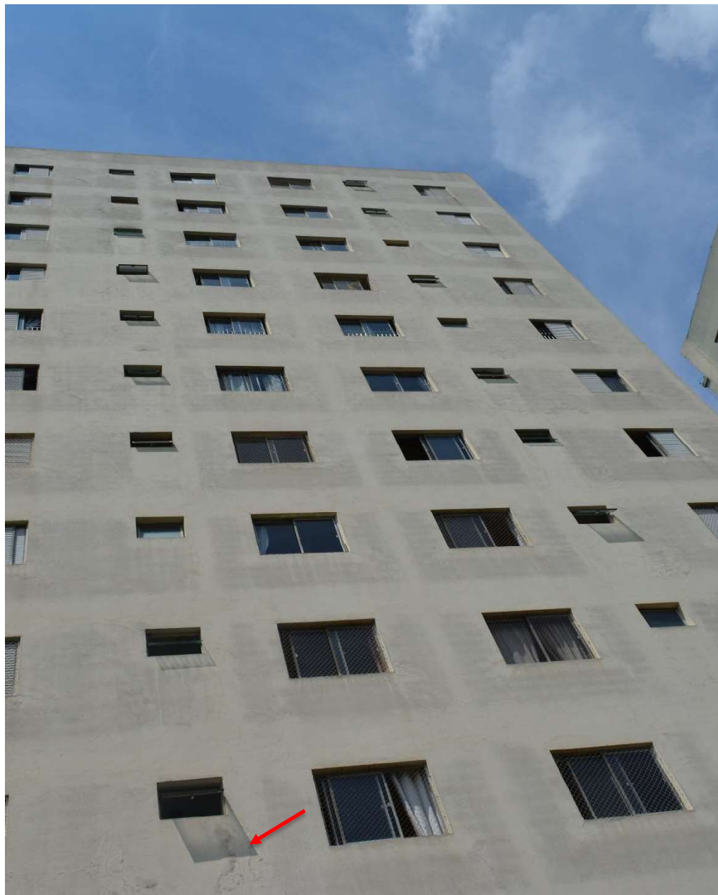
FOTO 03: VISTA DA FACHADA DO CONDOMÍNIO ONDE SE LOCALIZA A UNIDADE AVALIANDA, APRESENTA ALGUNS PONTOS DE INFILTRAÇÃO.
