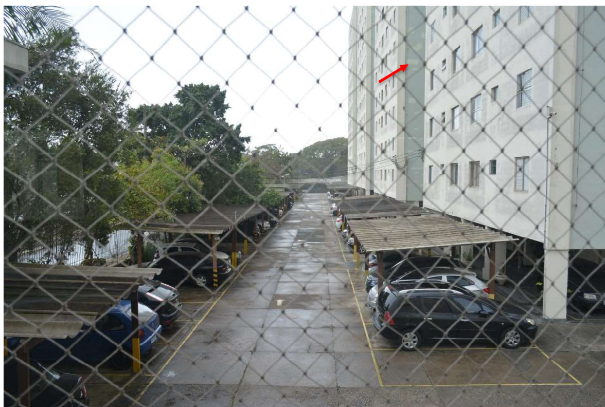
FOTO 29: VISTA EXTERNA DO SALÃO DE FESTAS, MOSTRA O BLOCO, O SEGUNDO DO MAIS PRÓXIMO PARA O MAIS LONGE, COM PONTOS DE PATOLOGIAS NA FACHADA.
