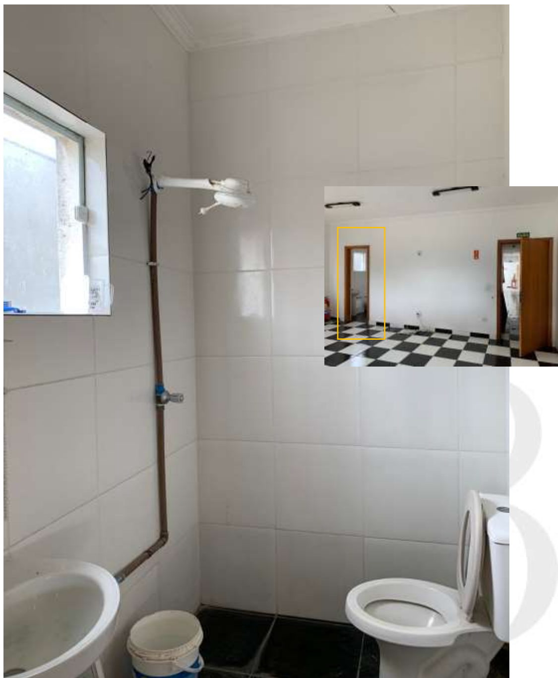
FOTO 26 Vista Geral e localizador do banheiro da sala. Constatação de improvisação de instalações hidrossanitárias.
