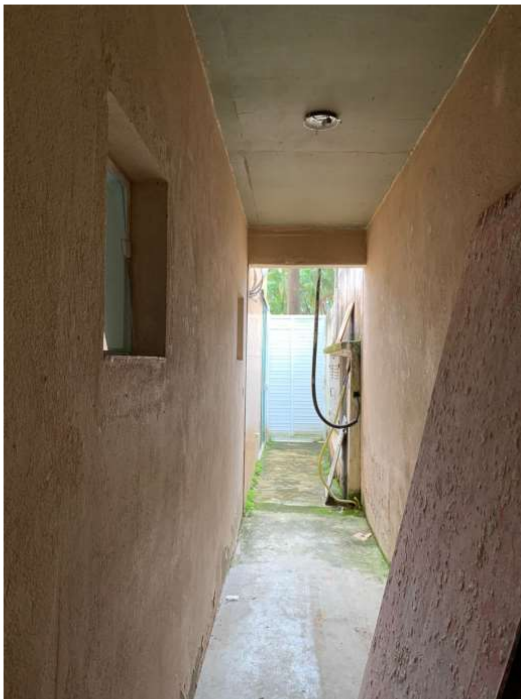
FOTO 28 – Detalhe da entrada lateral da fachada principal 01. Constatação da falta de manutenção e de energia desligada por falta de pagamento.
