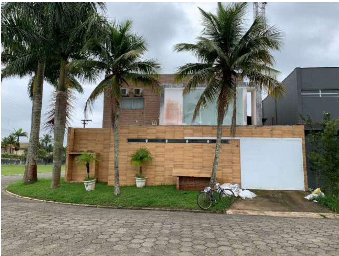
FOTO 7 – Detalhe da fachada principal 03. Constatação de Desplacamento de revestimento da fachada devido a falta de manutenção no imóvel.
