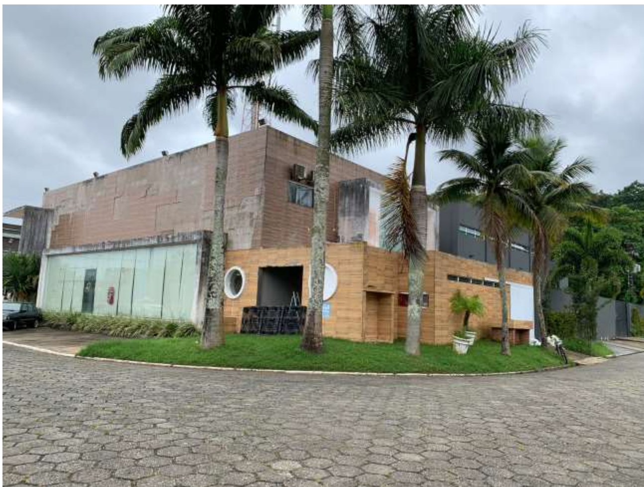
FOTO 6 – Vista Geral do imóvel – Fachada principal 02 e fachada principal 03. Constatação de deslocamento em todas as fachadas.
