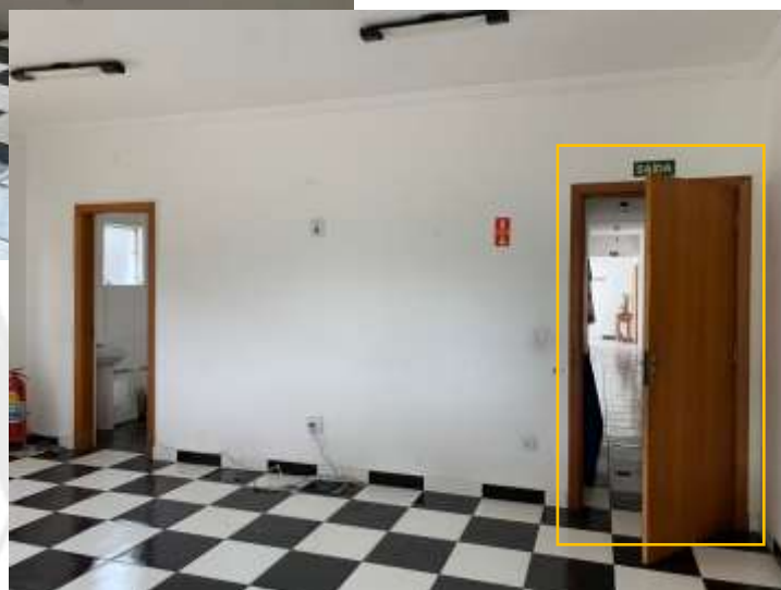
FOTO 25 – Vista Geral e localizador da sala. Constatação de falta de manutenção no local.
