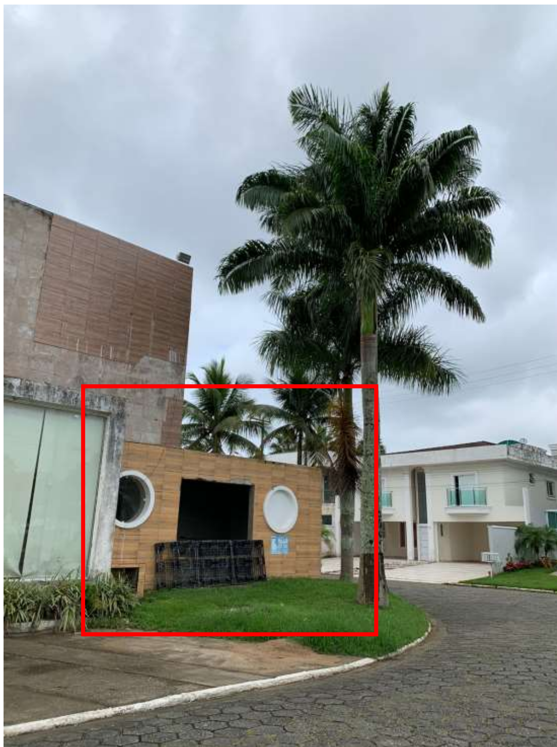
FOTO 4 - Detalhe da fachada principal 02. Constatação de imóvel sem portão de fechamento, conforme marcação em vermelho.
