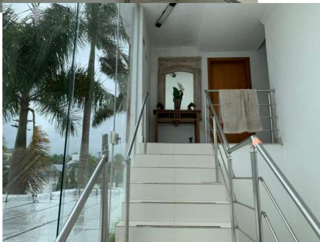
FOTO 20 – Detalhe do acesso ao segundo pavimento. Constatação de materiais de acabamento nobres e falta de manutenção tendo como origem a falta de estanqueidade das fachadas.
