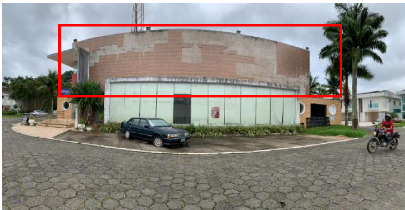
FOTO 3 - Vista Geral da Fachada principal 02. Constatação de deslocamento do revestimento na fachada, conforme marcação em vermelho.
