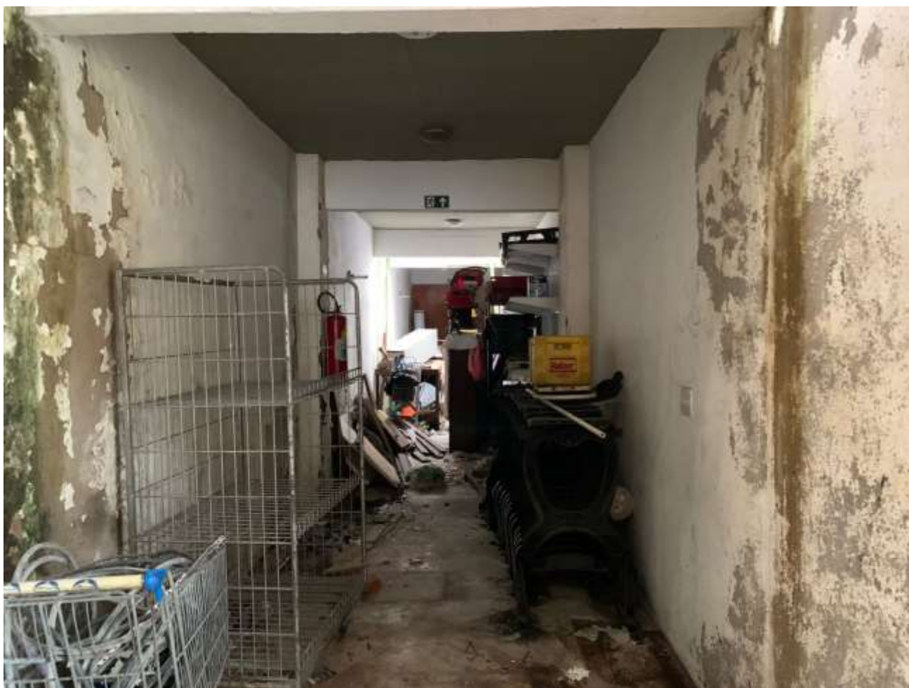
FOTO 27 - Vista Geral do Corredor com falta de manutenção predial e acúmulo de sucata.
