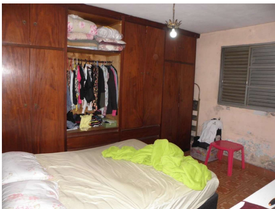
Foto: Quarto, com infiltrações nas paredes.
