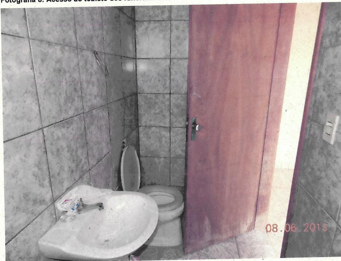
Fotografia 9: Visão geral do toaleta dos funcionários.
