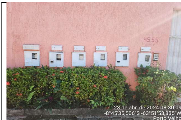
Foto 06: Vista dos quadros de energia
