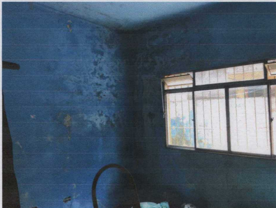
Foto 9- Vista da sala (c/ vazamentos).
