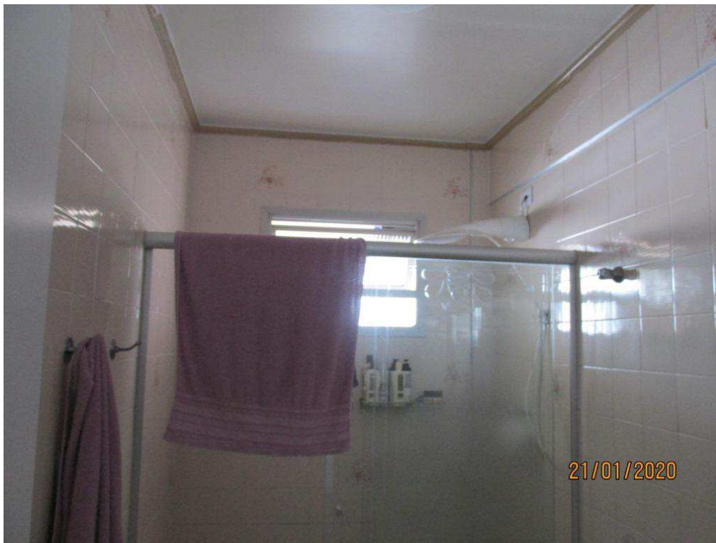
Foto 27 - Banheiro completo com box de vidro
