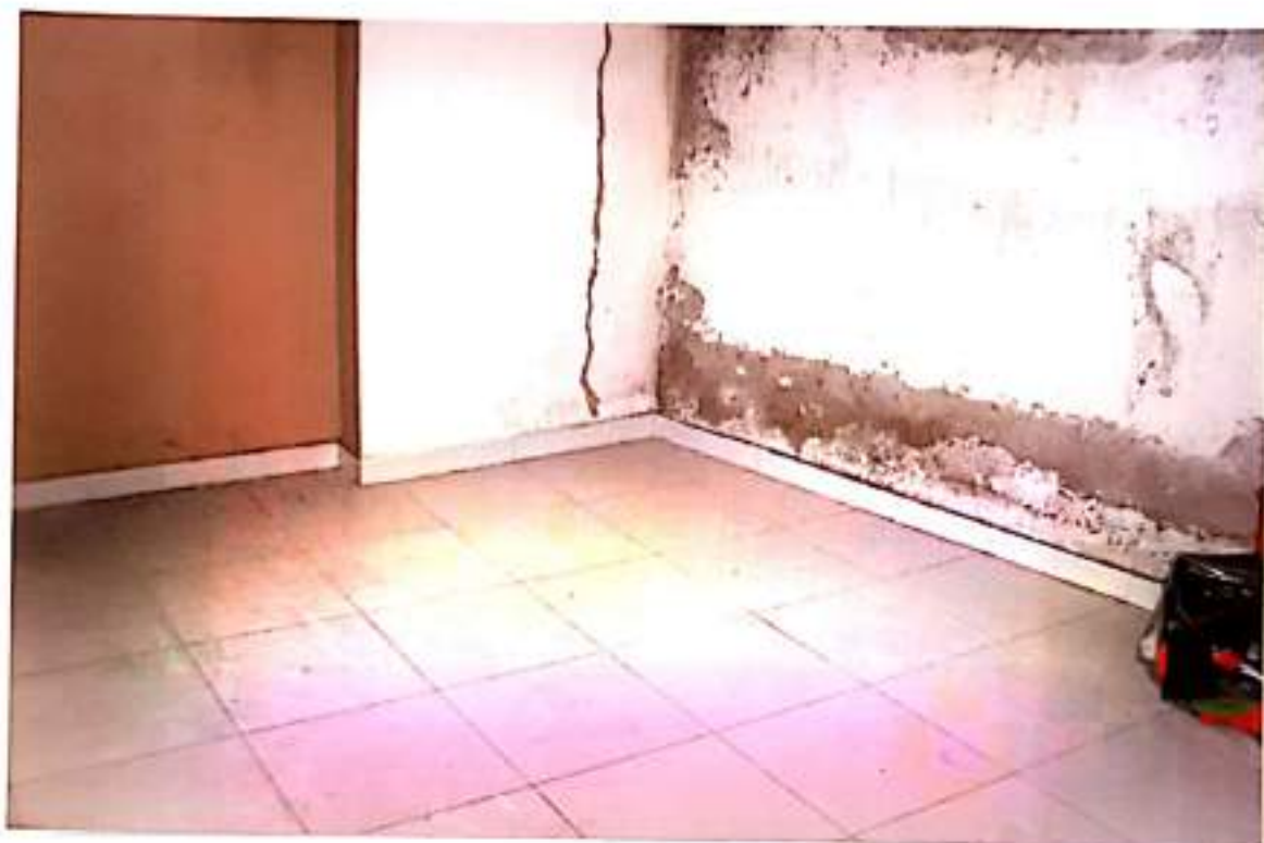
foto 33 – parede com reboco e pintura danificados demonstrando mau estado de conservação
