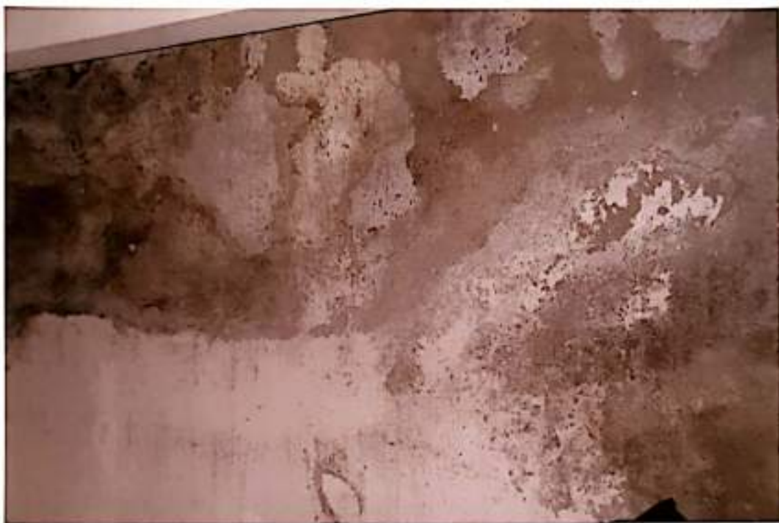
foto 31 – detalhe de revestimento de parede e pintura danificados demonstrando mau estado de conservação
