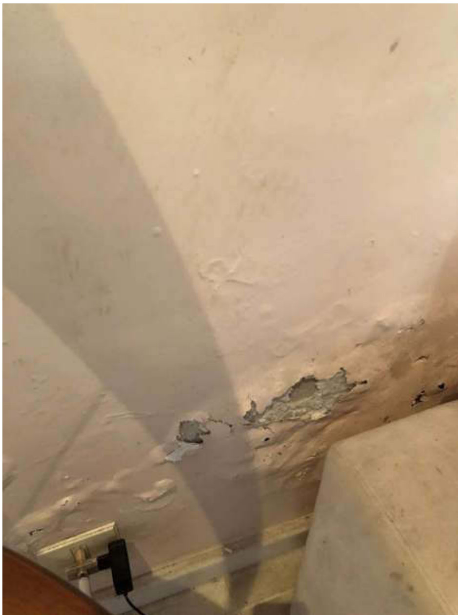
Figura 30: sala de estar 1 - marcas aparentes de infiltração
