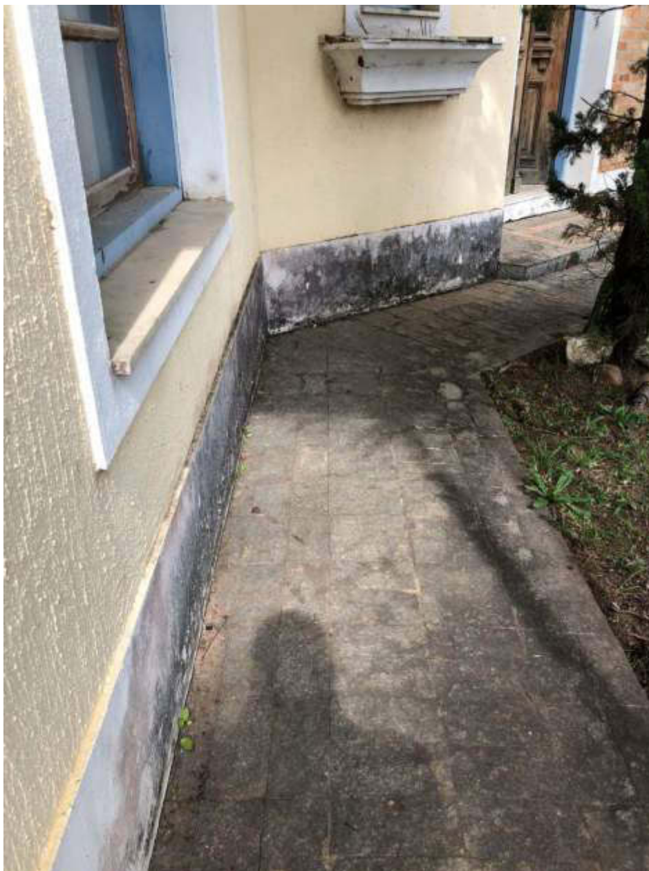
Figura 22: marcas que sugerem infiltração
