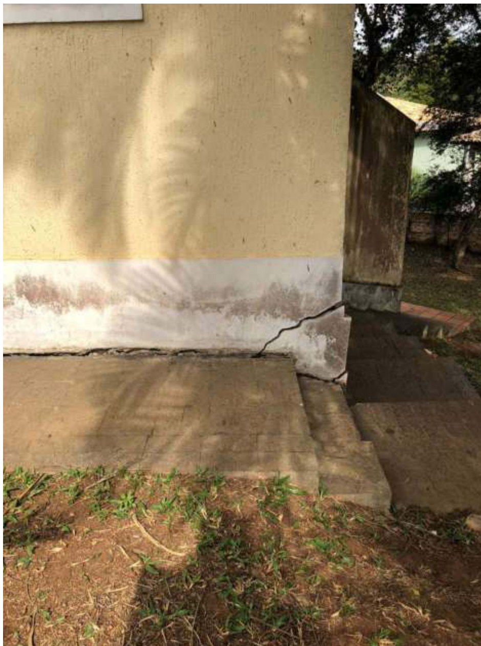
Figura 20: rachadura na estrutura do Imóvel Avaliando
