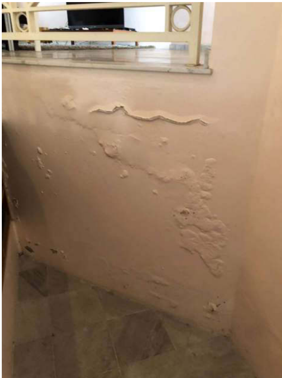
Figura 31: sala de estar 1 - marcas aparentes de infiltração
