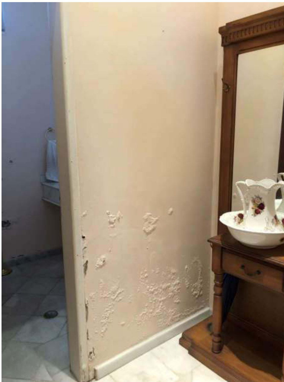
Figura 28: marcas aparentes de infiltração no lavabo
