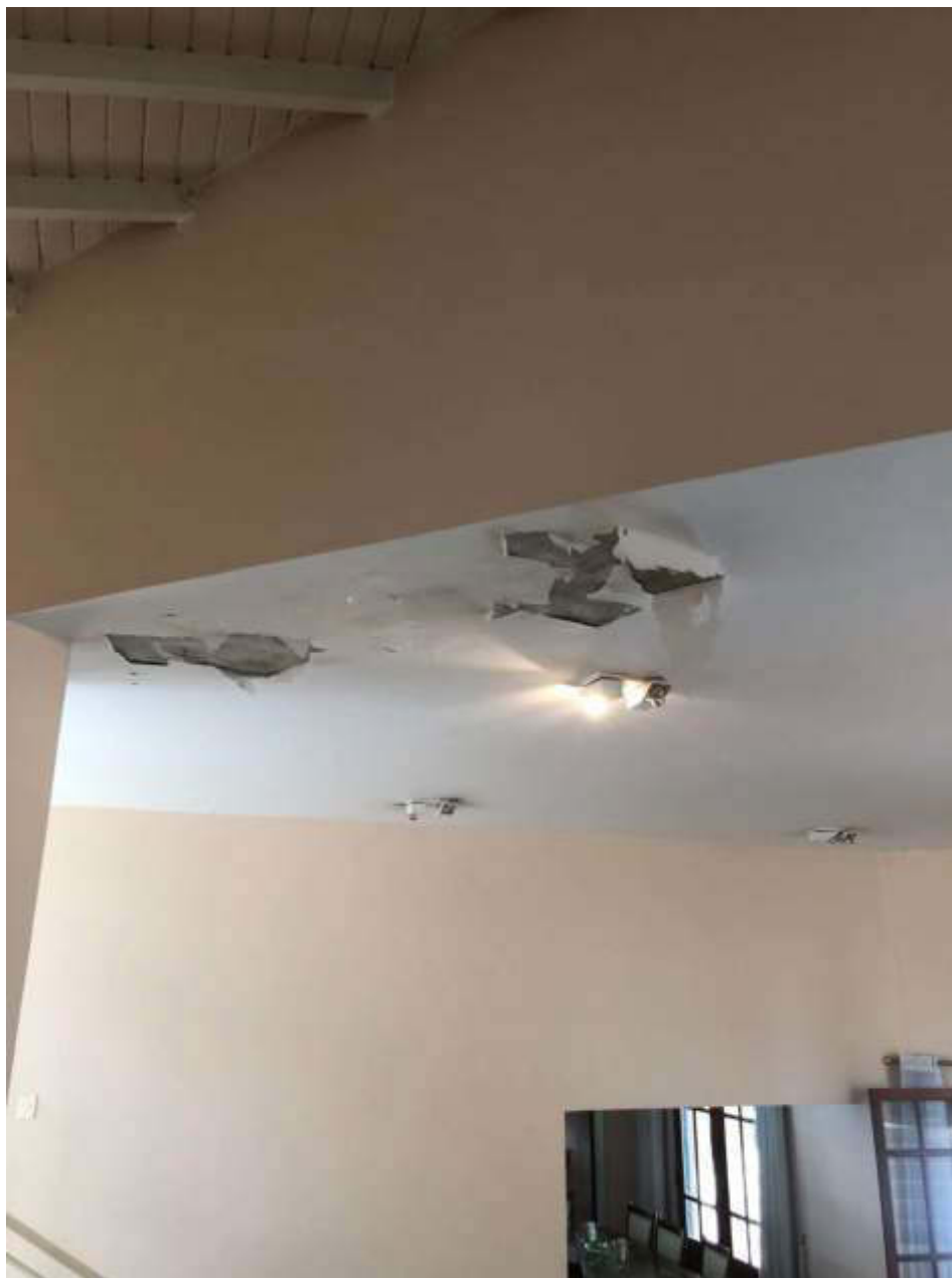
Figura 37: sala de estar 1 – teto com marcas de infiltração
