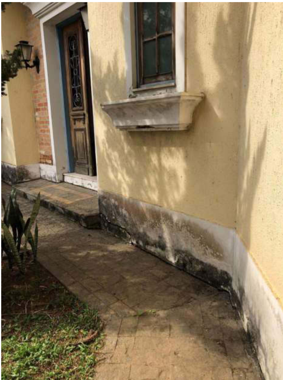
Figura 21: rachadura na estrutura do Imóvel Avaliando
