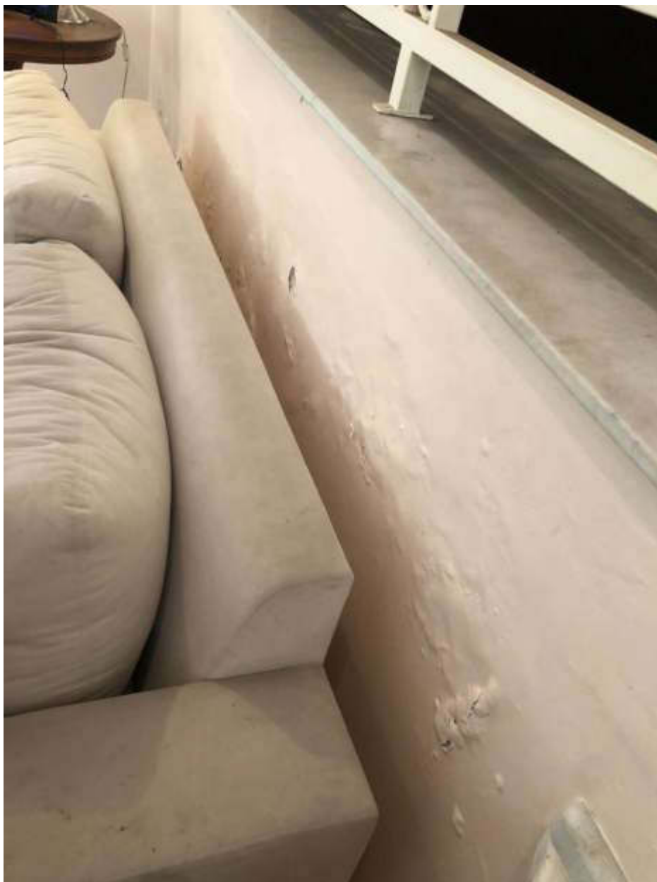
Figura 29: sala de estar 1 - marcas aparentes de infiltração
