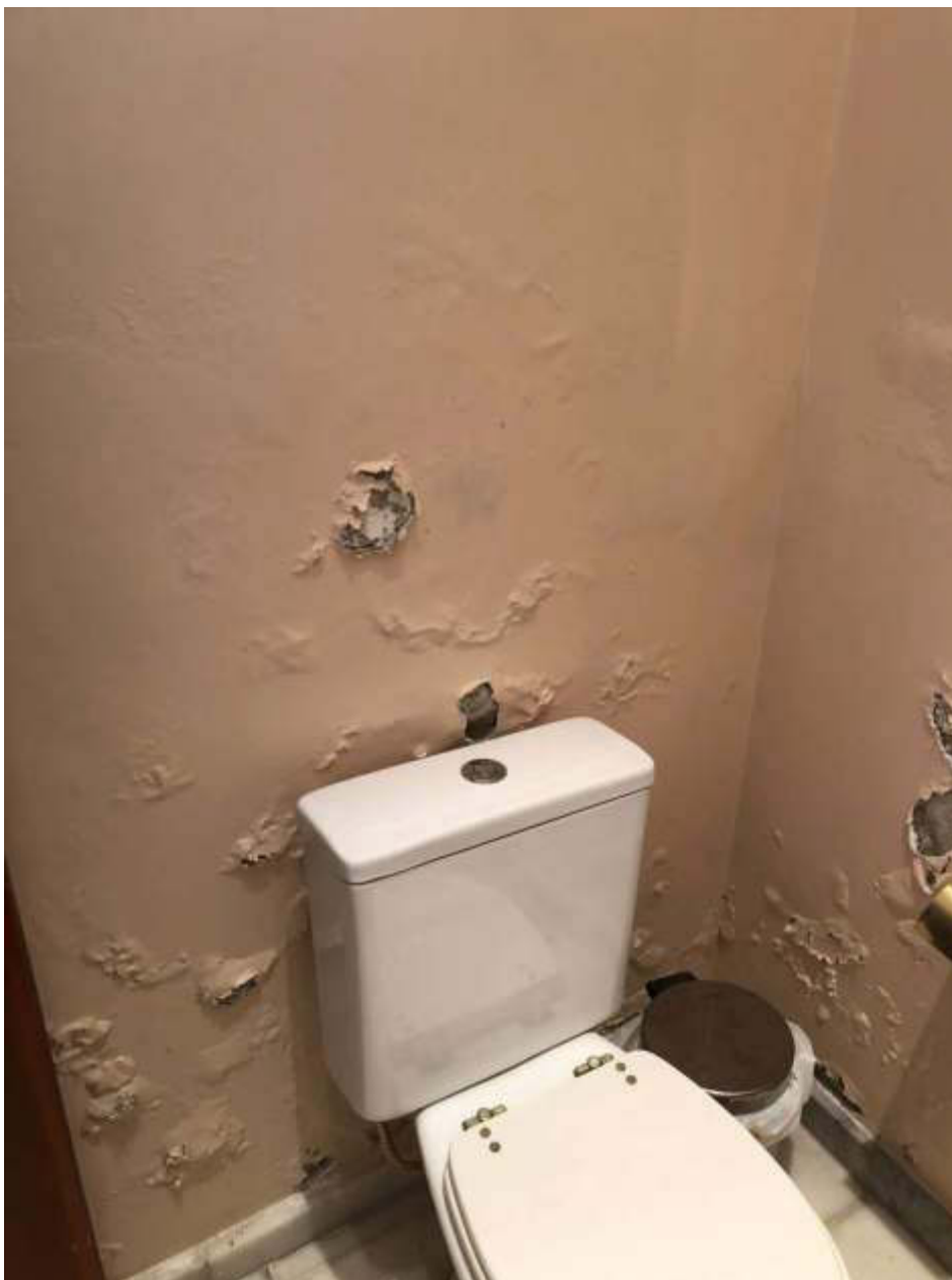
Figura 26: marcas aparentes de infiltração no lavabo
