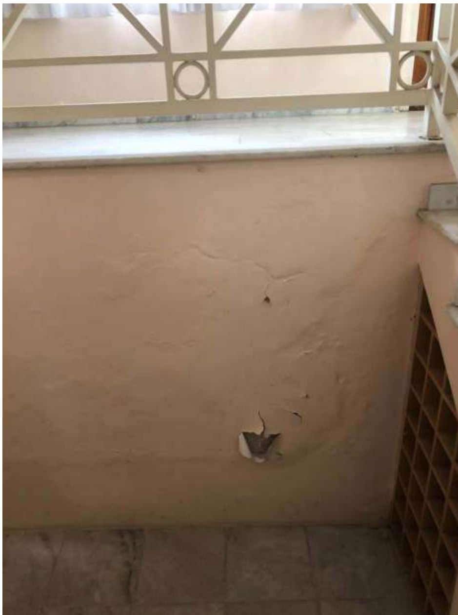
Figura 32: sala de estar 1 - marcas aparentes de infiltração
