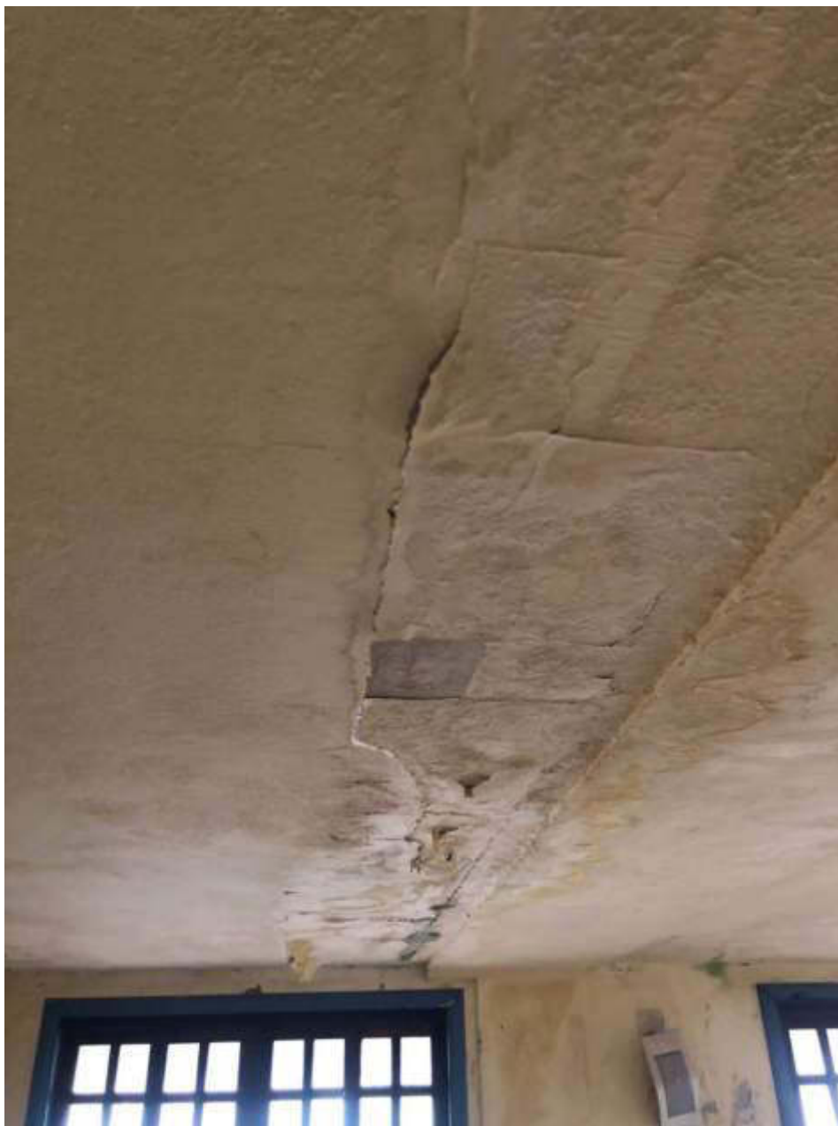
Figura 76: marcas aparentes de infiltração e rachadura do teto
