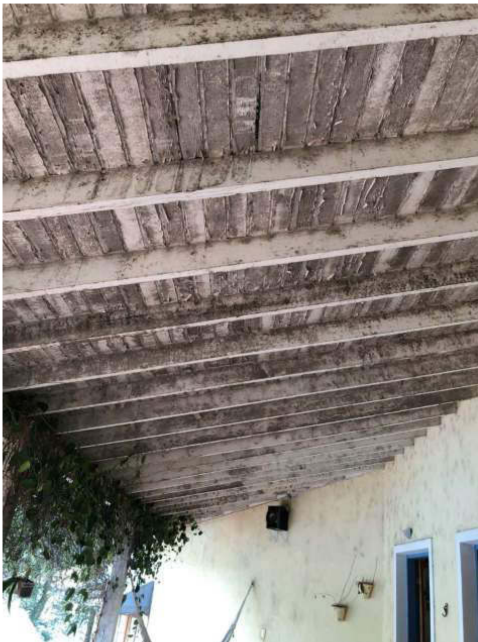
Figura 67: beiral do telhado – desgastado
