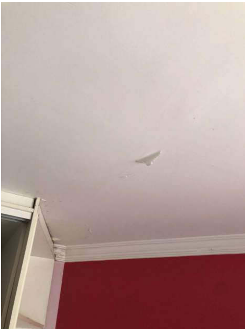
Figura 41: suíte 1 - marcas de fissuras no teto
