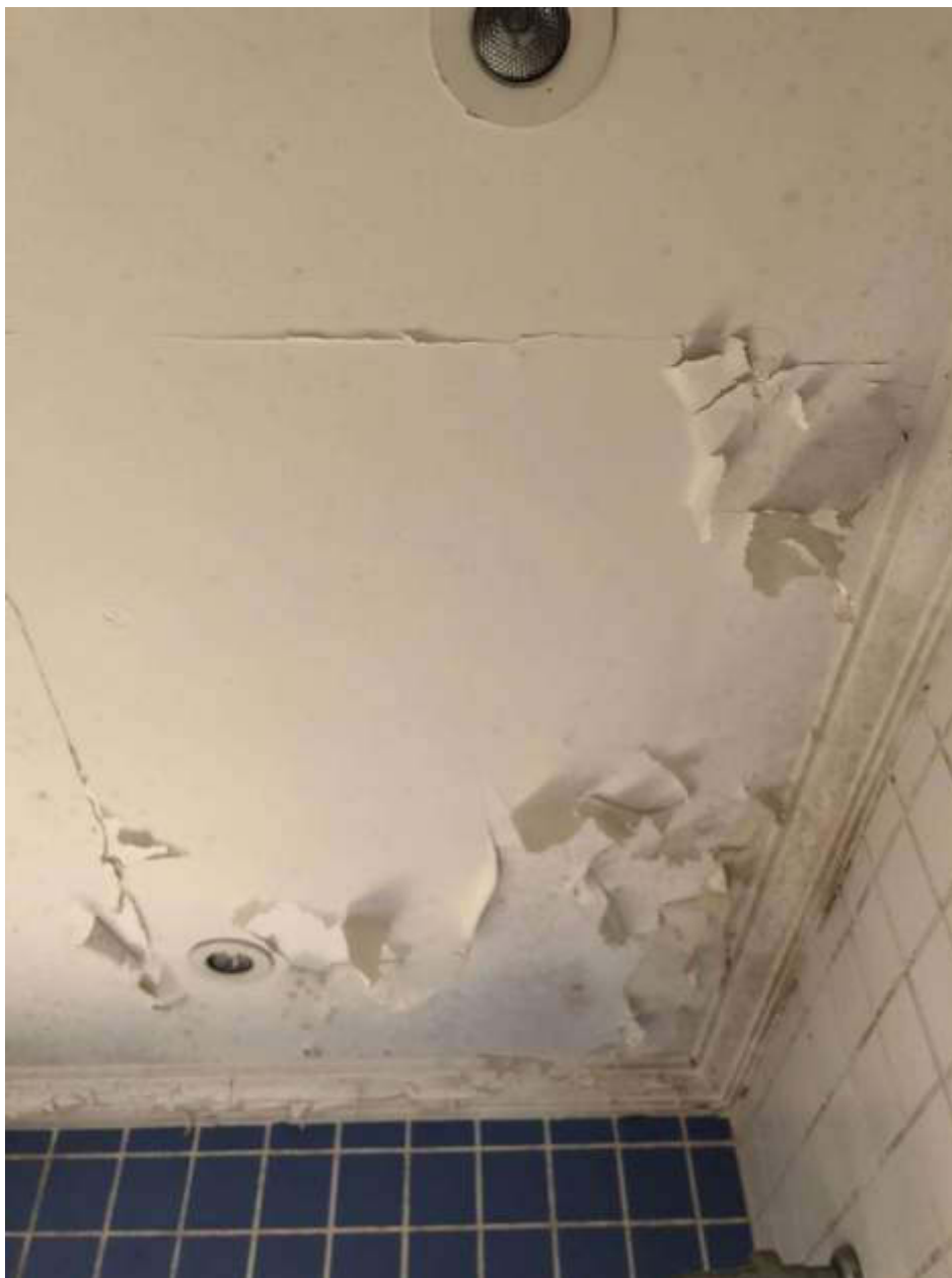
Figura 46: suíte 1 – banheiro com marcas de infiltração no teto
