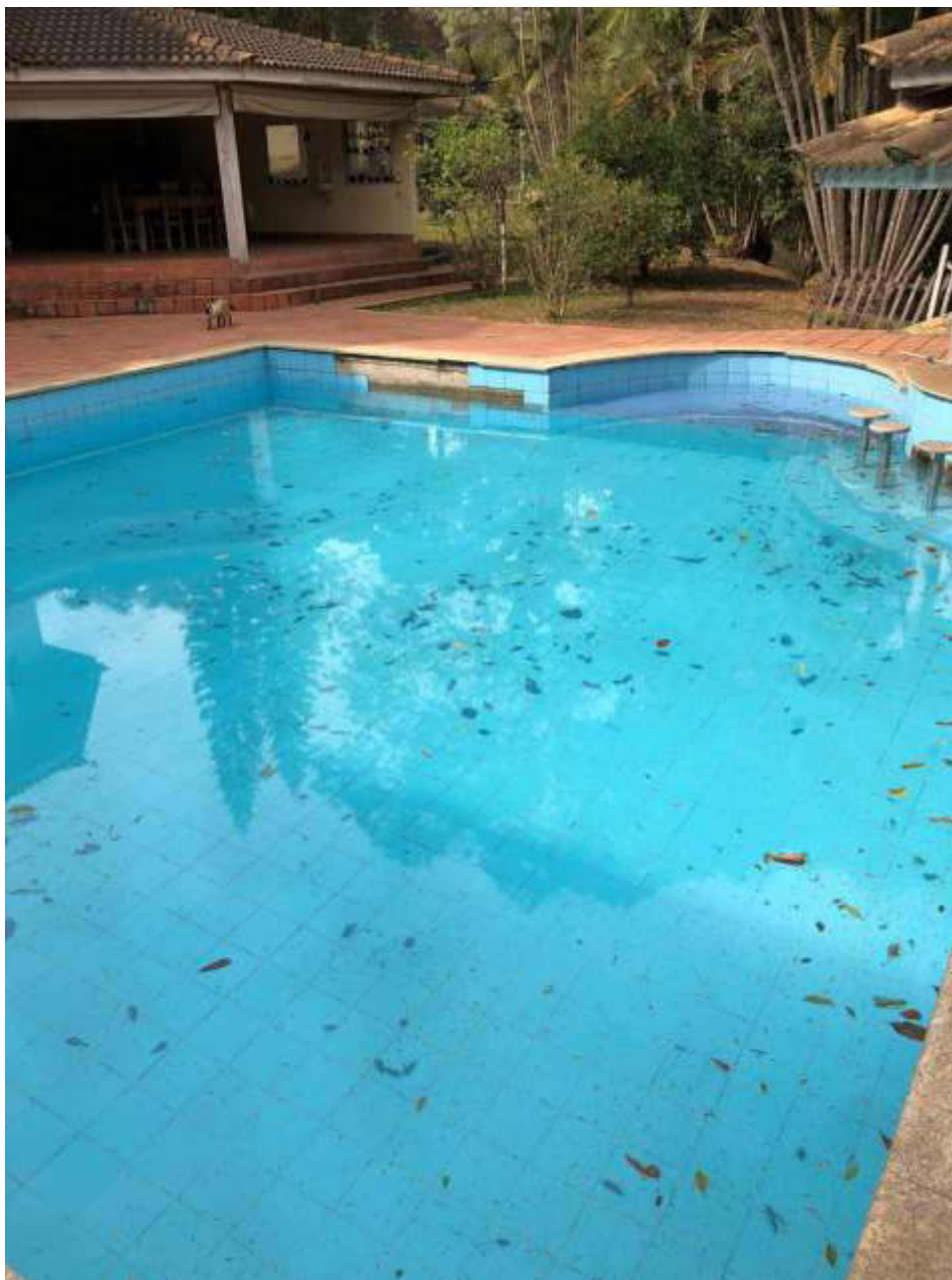
Figura 71: piscina com partes sem revestimento
