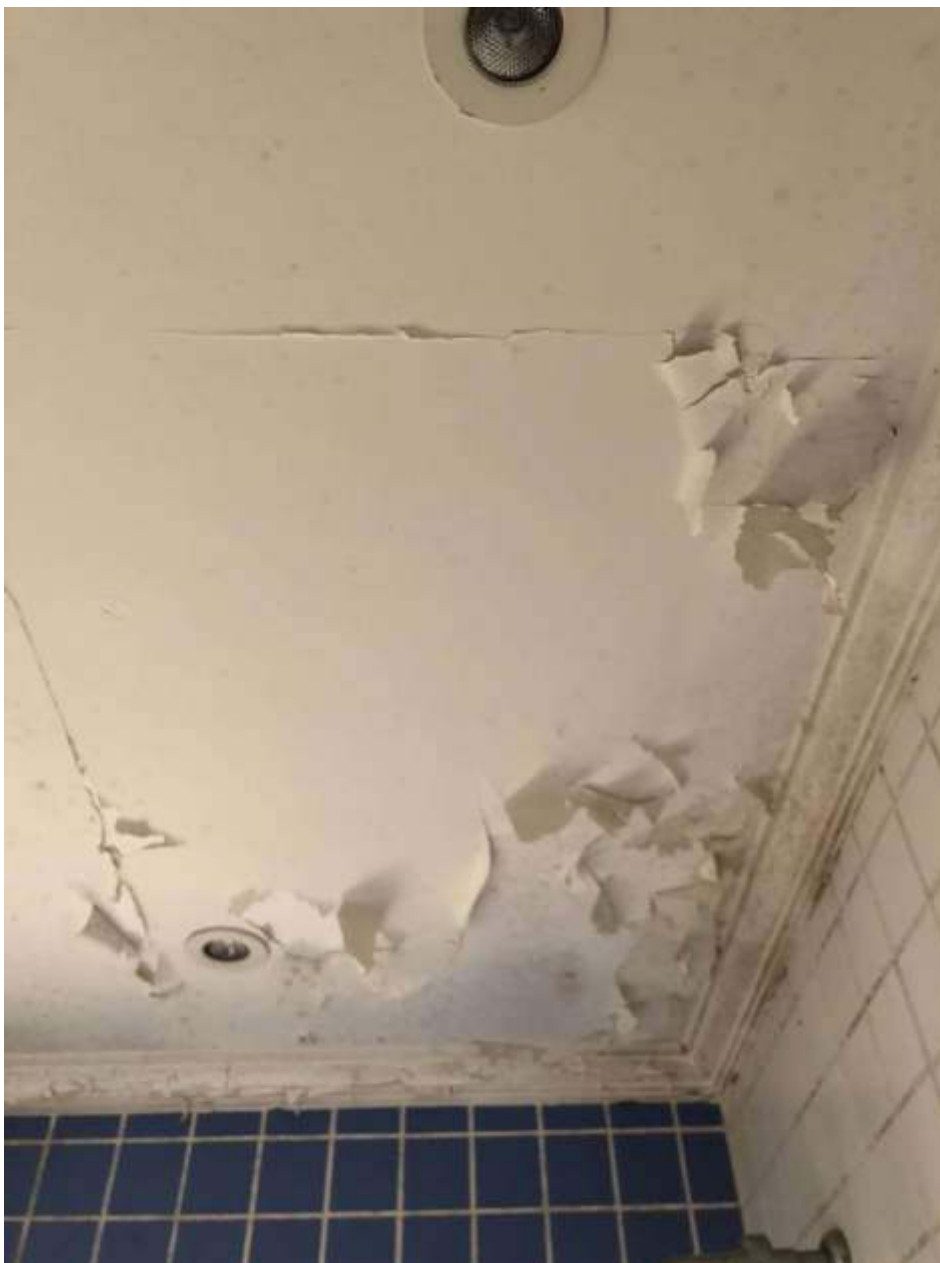
Figura 53: suíte 2 – banheiro com marcas de infiltração no teto
