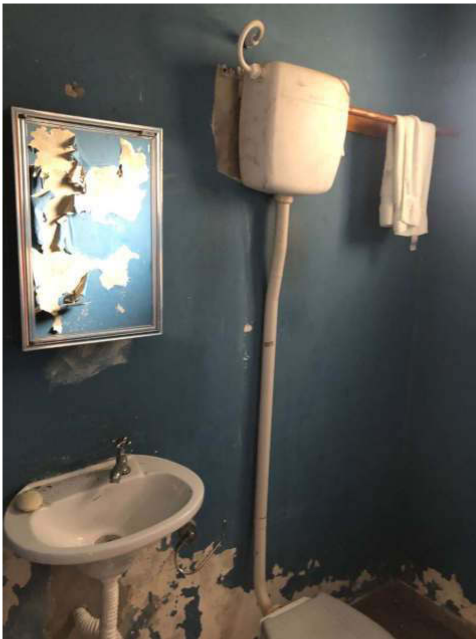
Figura 86: edícula de caseiro – marcas de infiltração no banheiro
