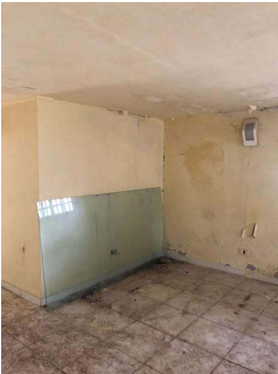
Figura 77: marcas aparentes de infiltração e rachadura do teto
