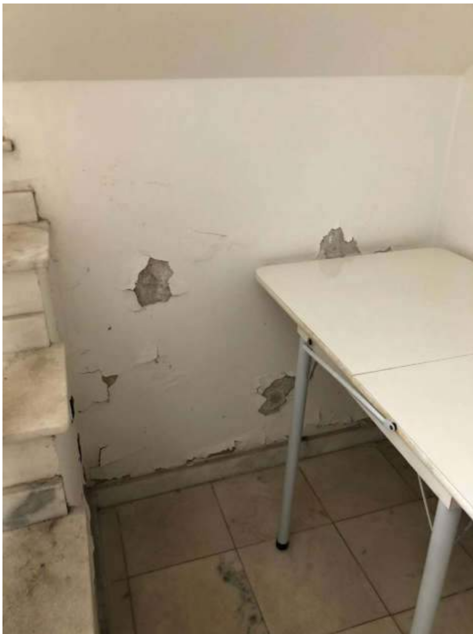
Figura 89: escada de acesso às suítes 3 e 4 – marcas de infiltração
