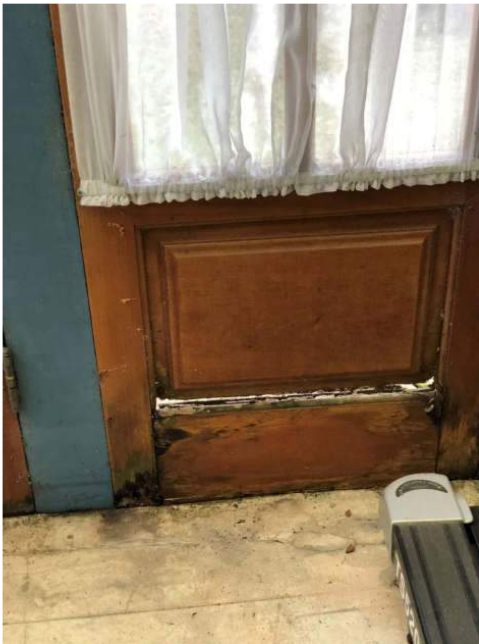
Figura 119: sala de ginástica – porta podre
