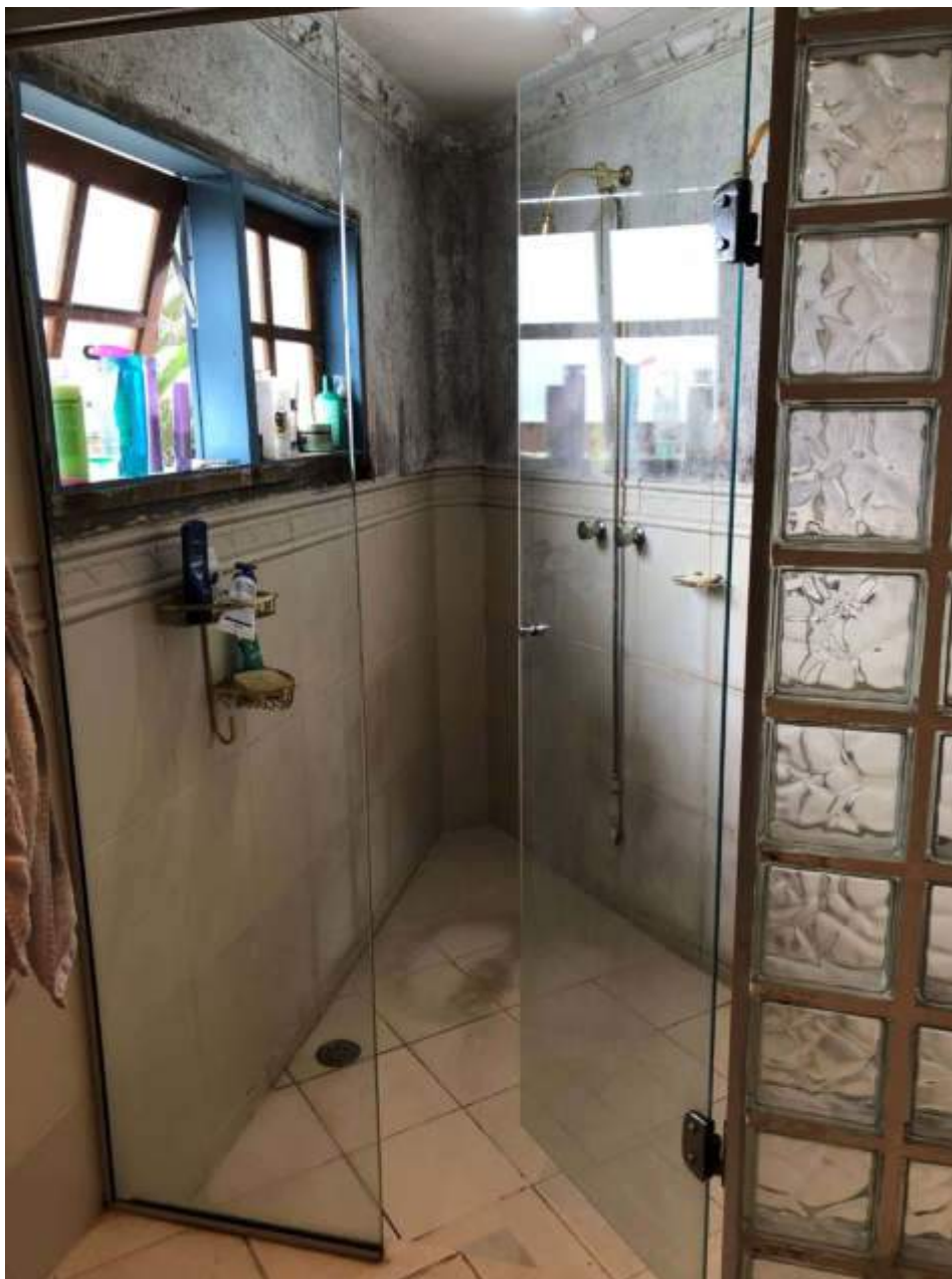
Figura 108: suíte 4 - banheiro - marcas de infiltração nas paredes e teto
