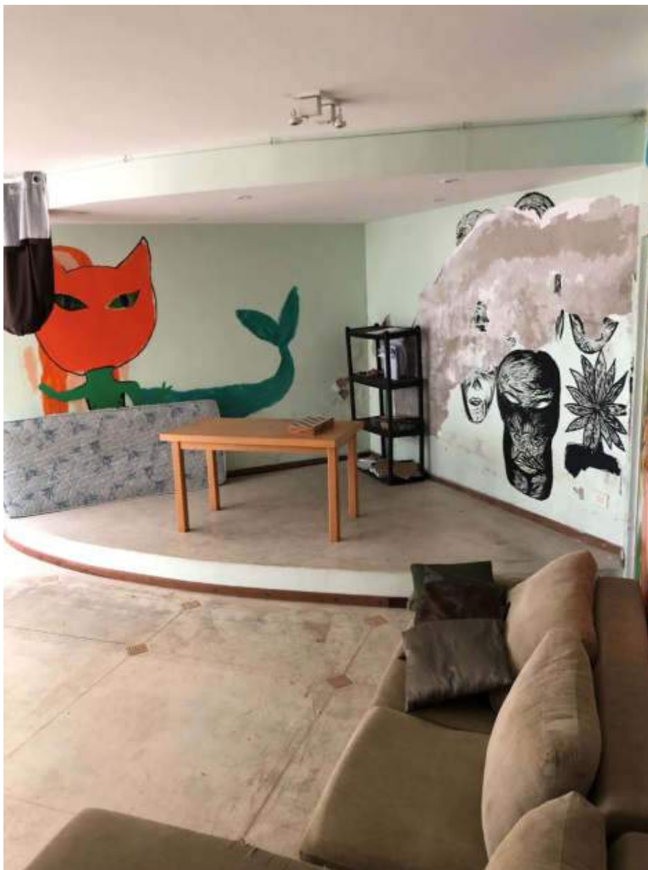
Figura 116: sala de ginástica – marcas de infiltração na parede
