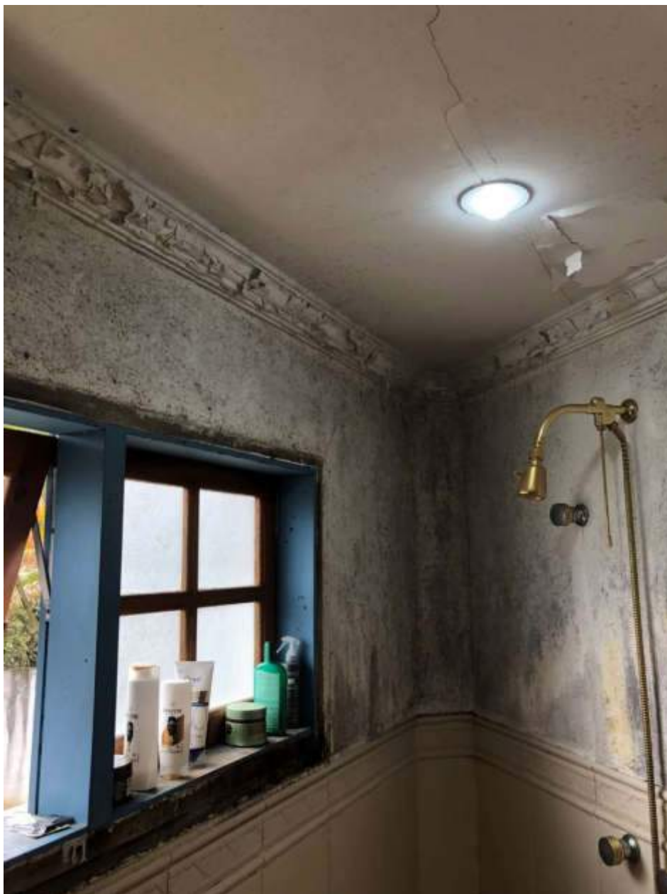
Figura 110: suíte 4 - banheiro - marcas de infiltração nas paredes e teto
