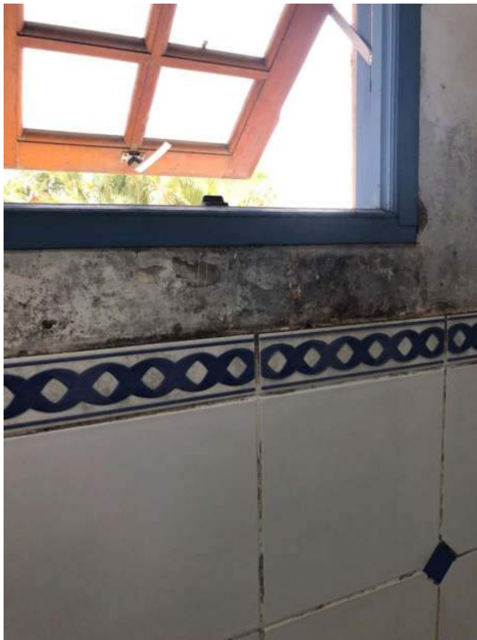
Figura 97: suíte 3 – banheiro – marcas de infiltração na parede
