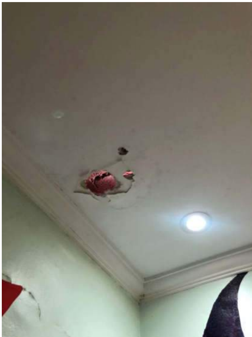
Figura 120: teto da sala de ginástica – marcas de fissuras e infiltração
