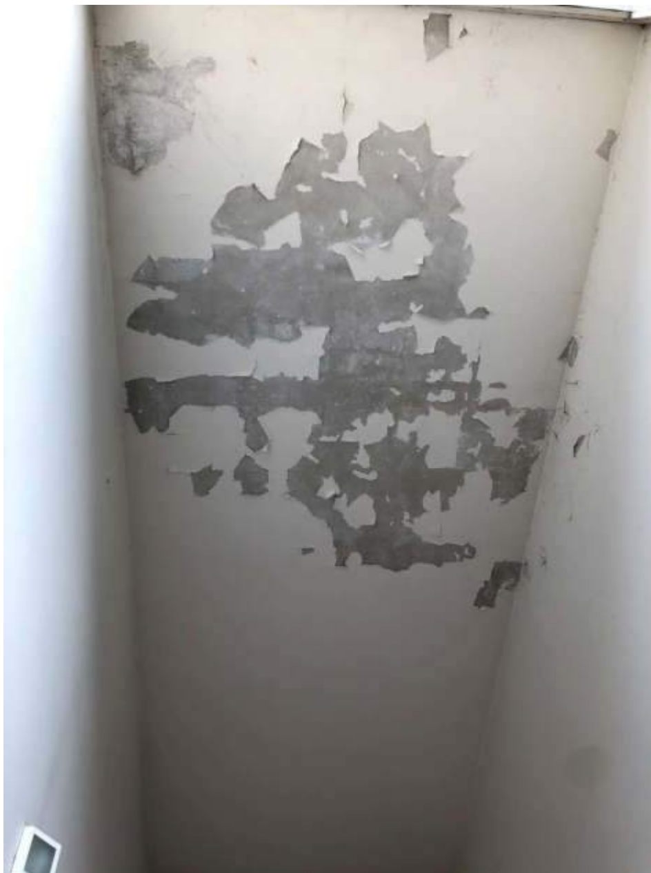
Figura 92: teto do corredor com marcas de infiltração
