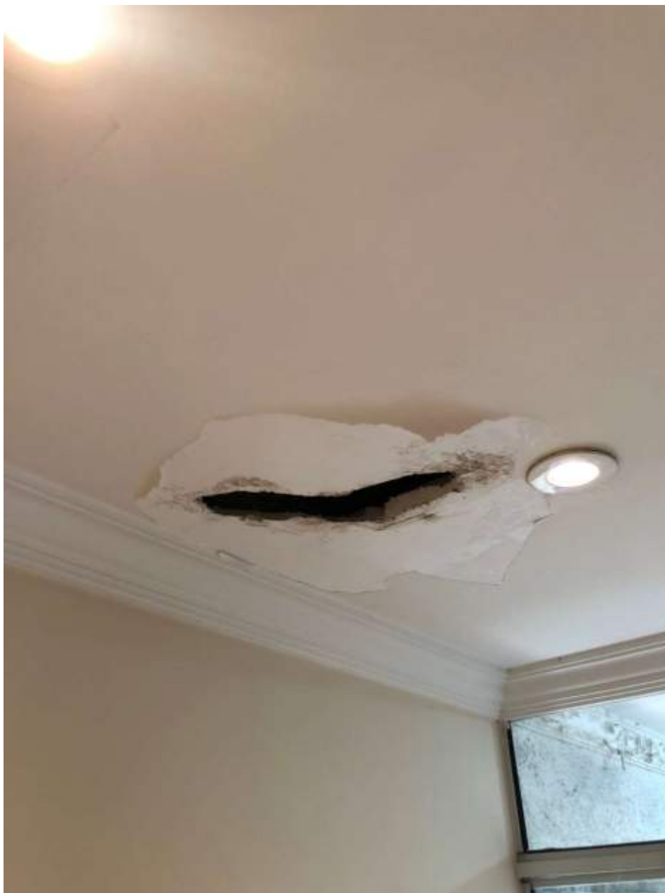
Figura 109: suíte 4 – furo no teto do banheiro – aparente infiltração
