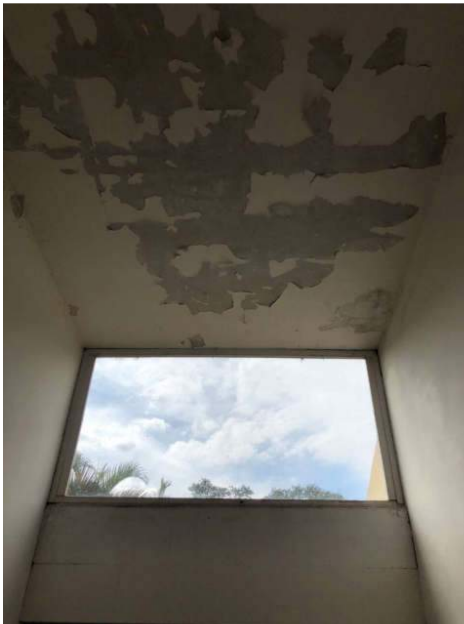
Figura 91: teto do corredor com marcas de infiltração
