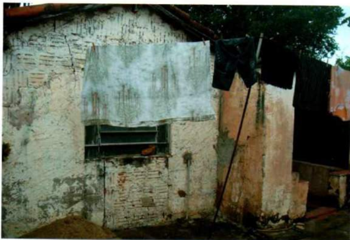
Vista parcial de construção existente na parte dos fundos, em mau estado de conservação e utilização.
