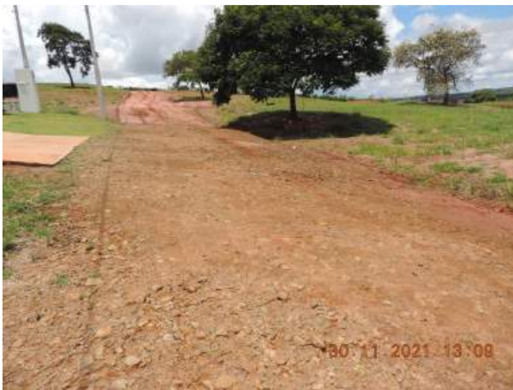
Foto 05 - Rua 135 sem pavimentação
