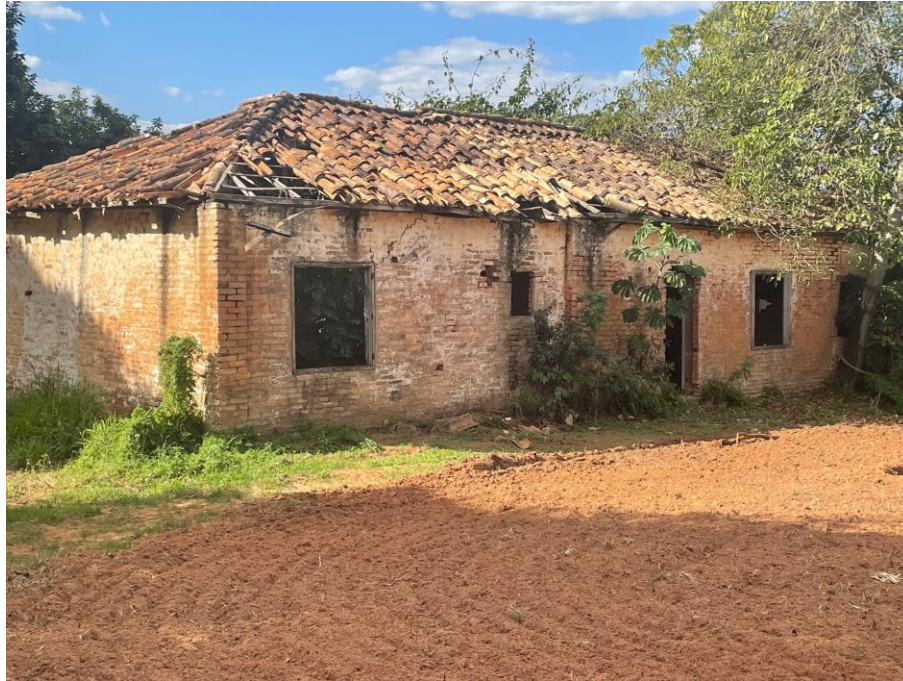
Foto n.º3: Vista da casa em péssimo estado de conservação.
