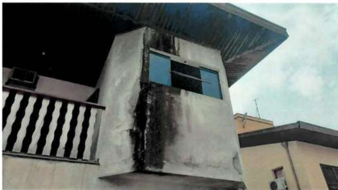
Foto 41. Vista das evidências patológicas
