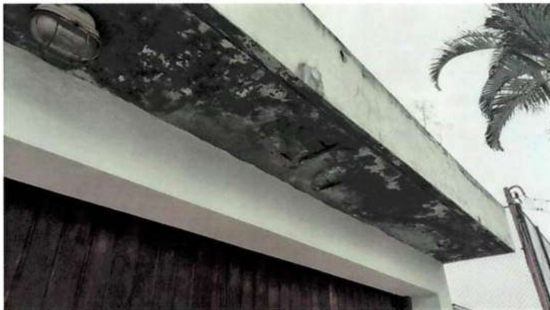
Foto 37. Vista das evidências patológicas.
