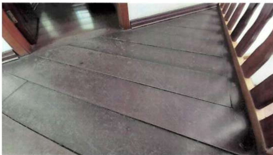
Foto 52. Vista das evidências patológicas
