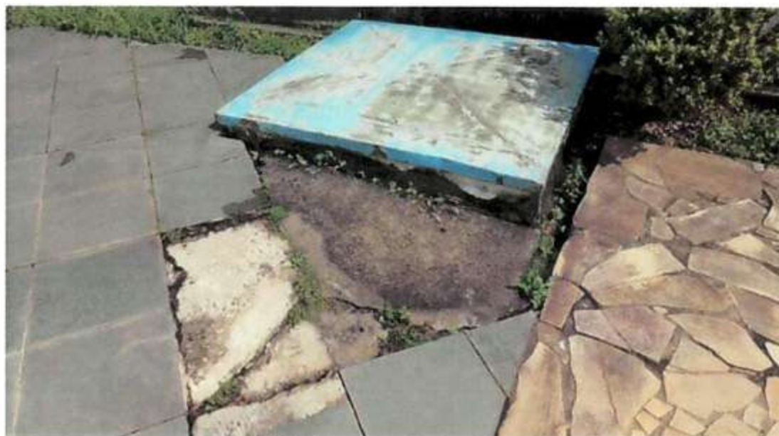
Foto 45. Vista das evidências patológicas
