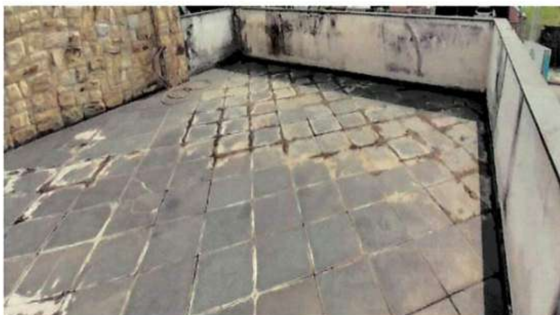
Foto 47. Vista das evidências patológicas
