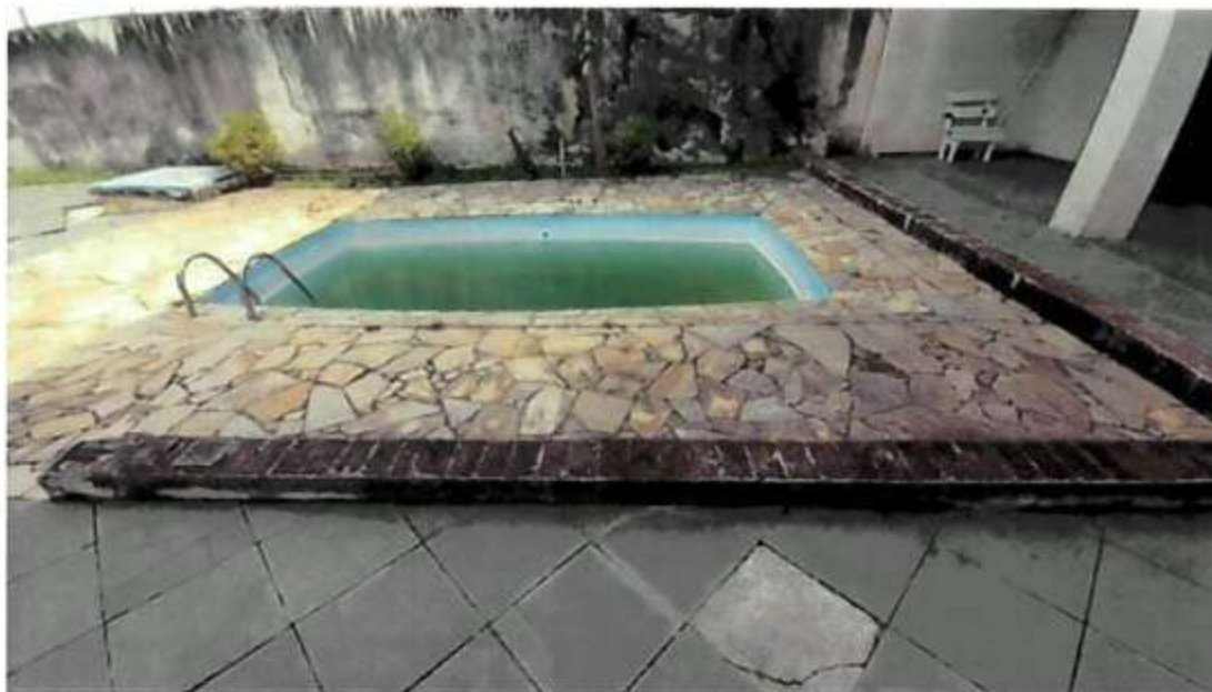
Foto 44. Vista das evidências patológicas
