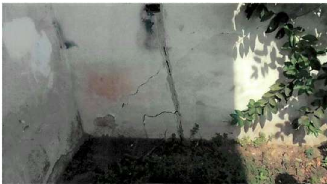
Foto 46. Vista das evidências patológicas
