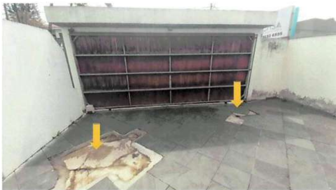
Foto 39. Vista das evidências patológicas
