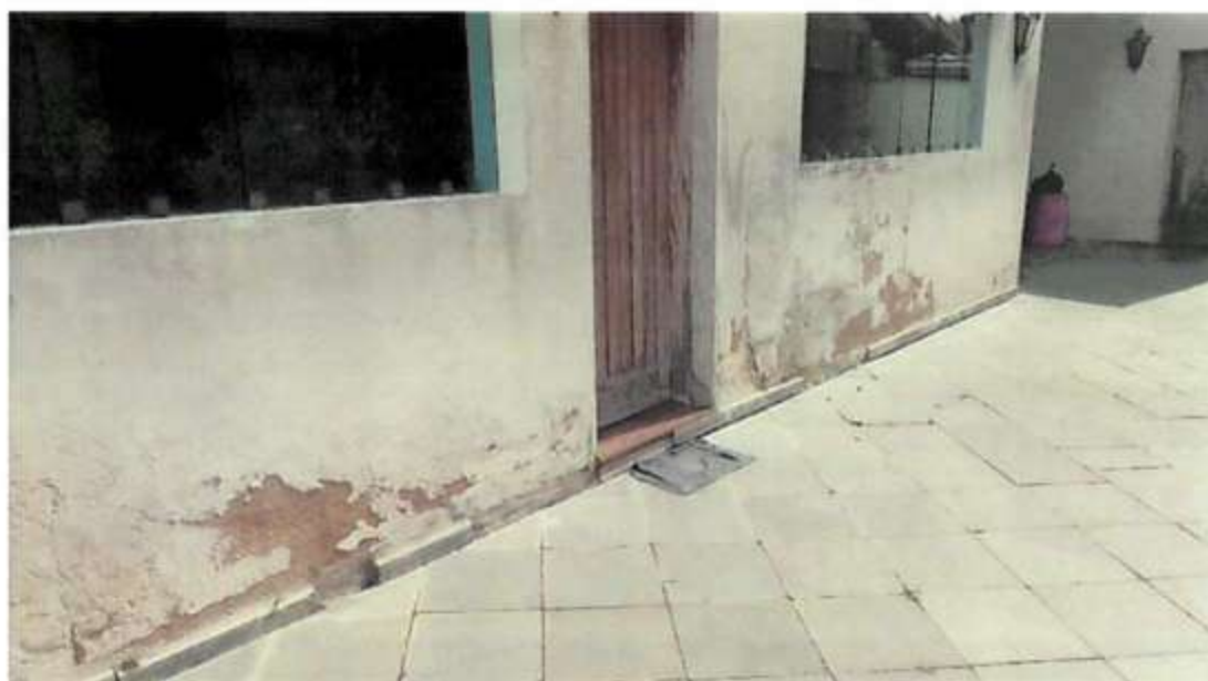
Foto 40. Vista das evidências patológicas.
