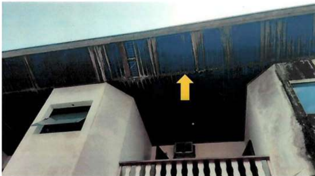
Foto 42. Vista das evidências patológicas
