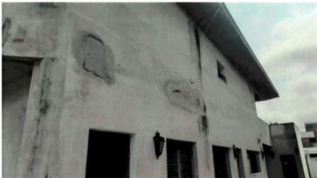
Foto 43. Vista das evidências patológicas
