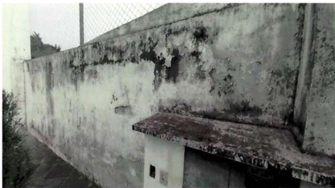
Foto 38. Vista das evidências patológicas.
