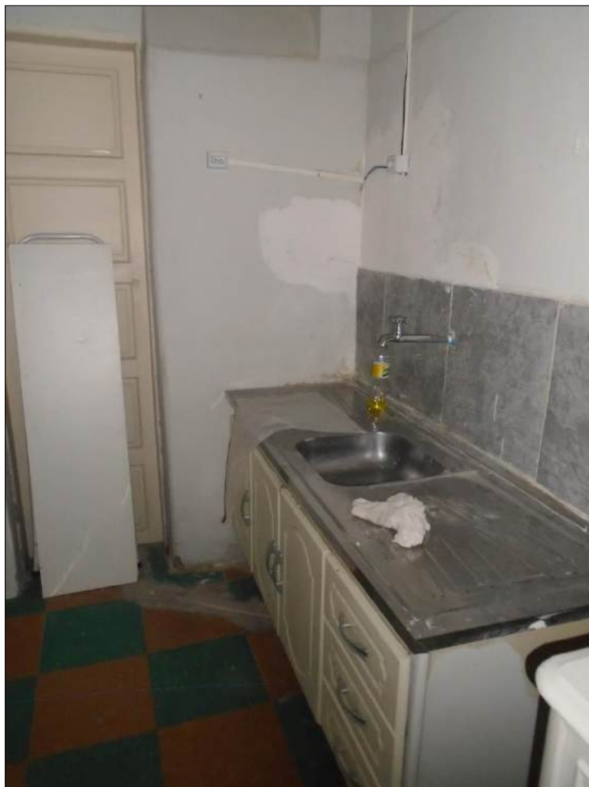
FOTO 16 – DETALHE DO ESTADO DO PISO E PAREDES.
