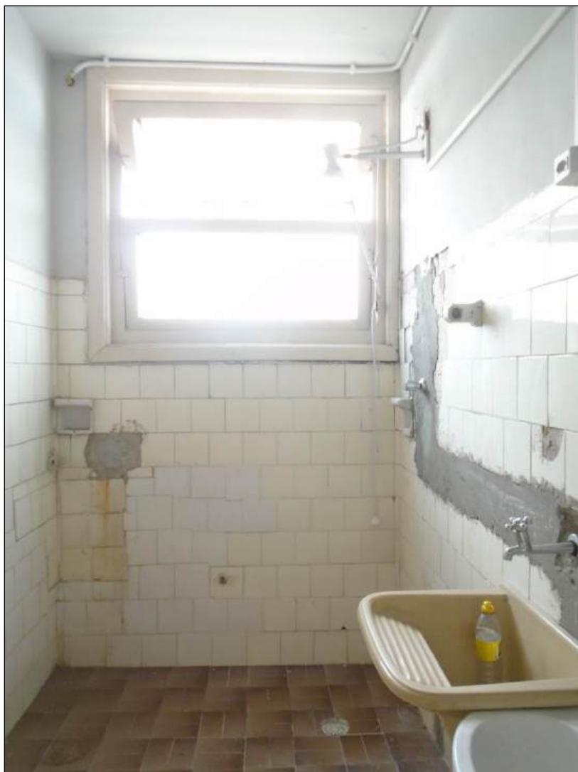
FOTO 22 – ESTADO IRREGULAR DO BOX DE CHUVEIRO.
