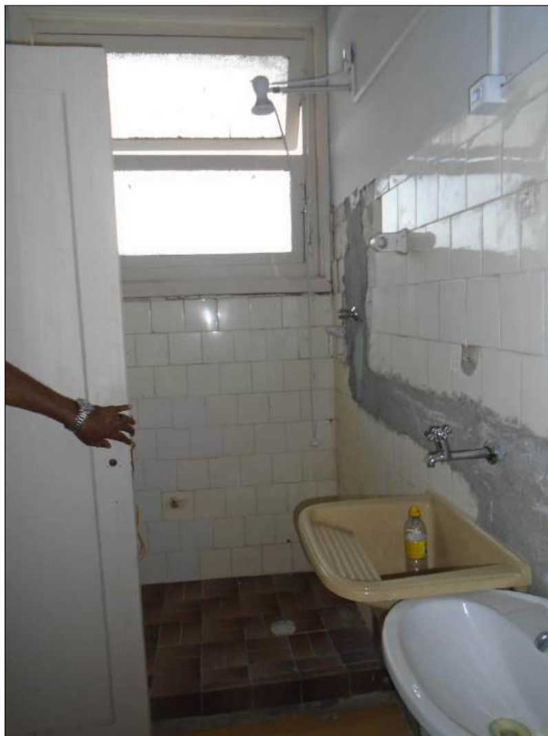
FOTO 21 – INDICAÇÃO DE LOUÇAS IMPROVISADAS NO BANHEIRO.
