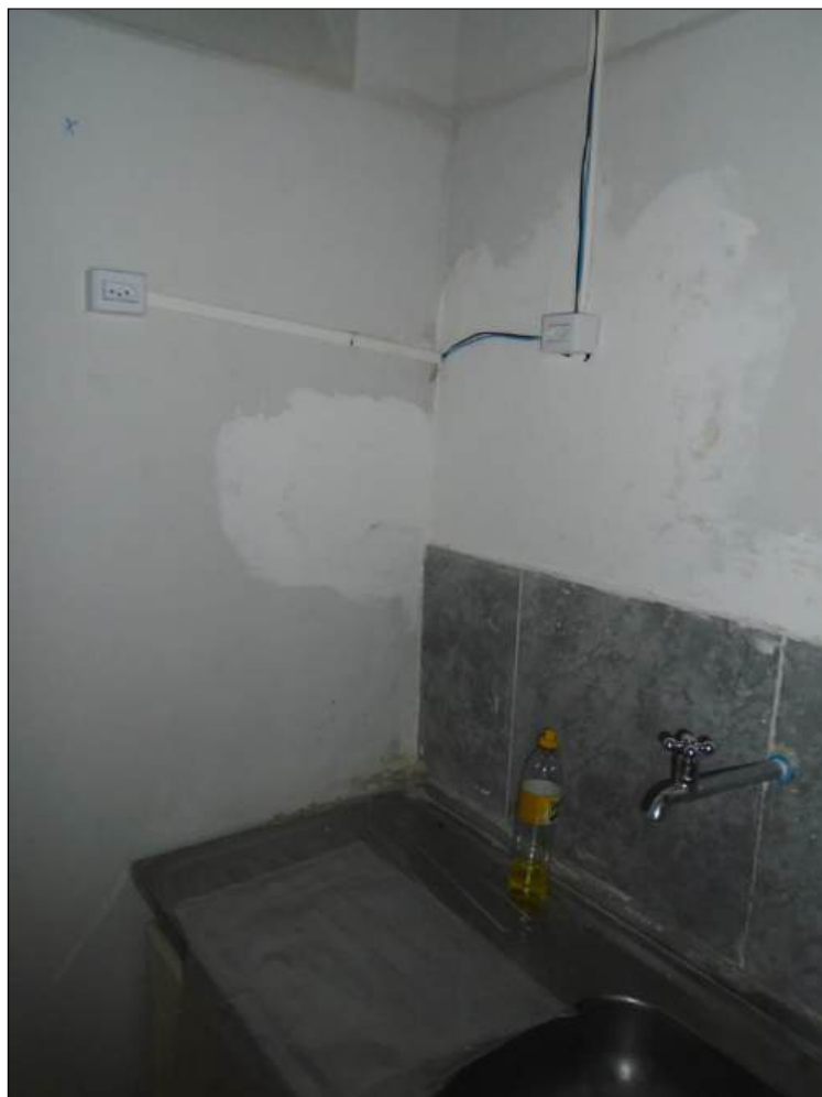
FOTO 17 – DETALHE DA FALTA DE MANUTENÇÃO PAREDES .
