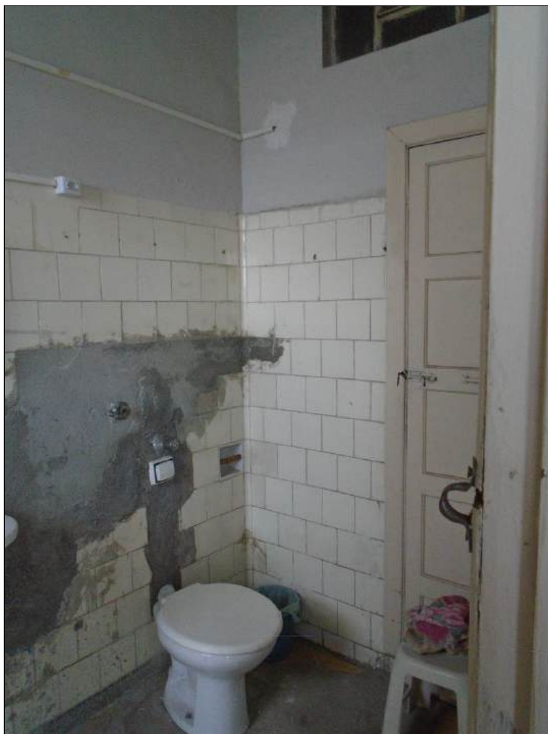
FOTO 20 – FALTA DE MANUTENÇÃO REVESTIMENTOS PISO E PAREDES.
