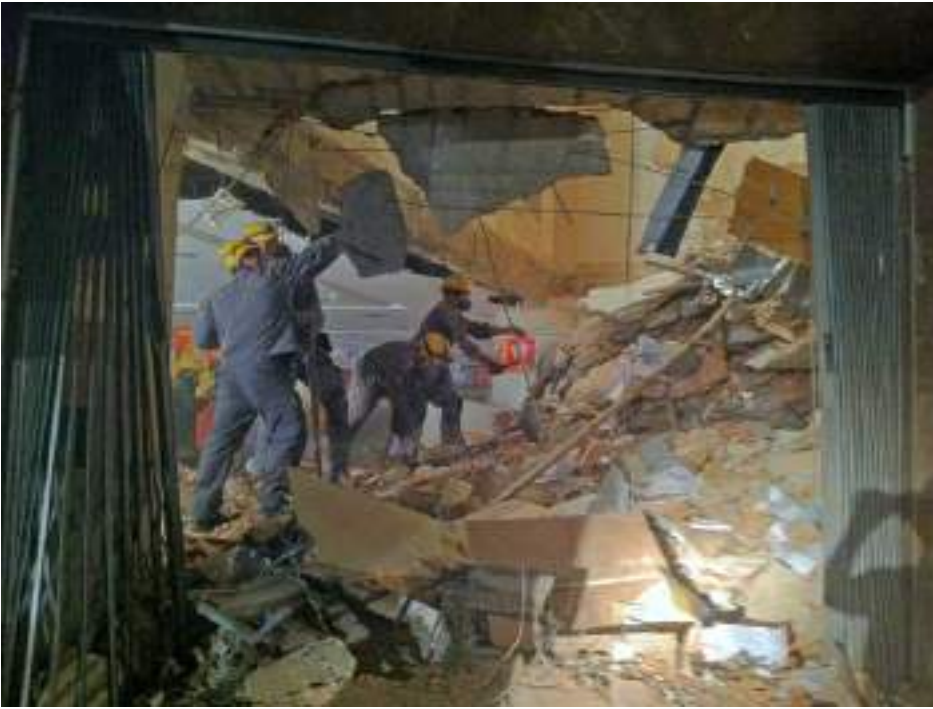
Por dentro, prédio ficou parcialmente destruído após desabamento de lajes. (Foto: Carlos Oliveira / G1)
