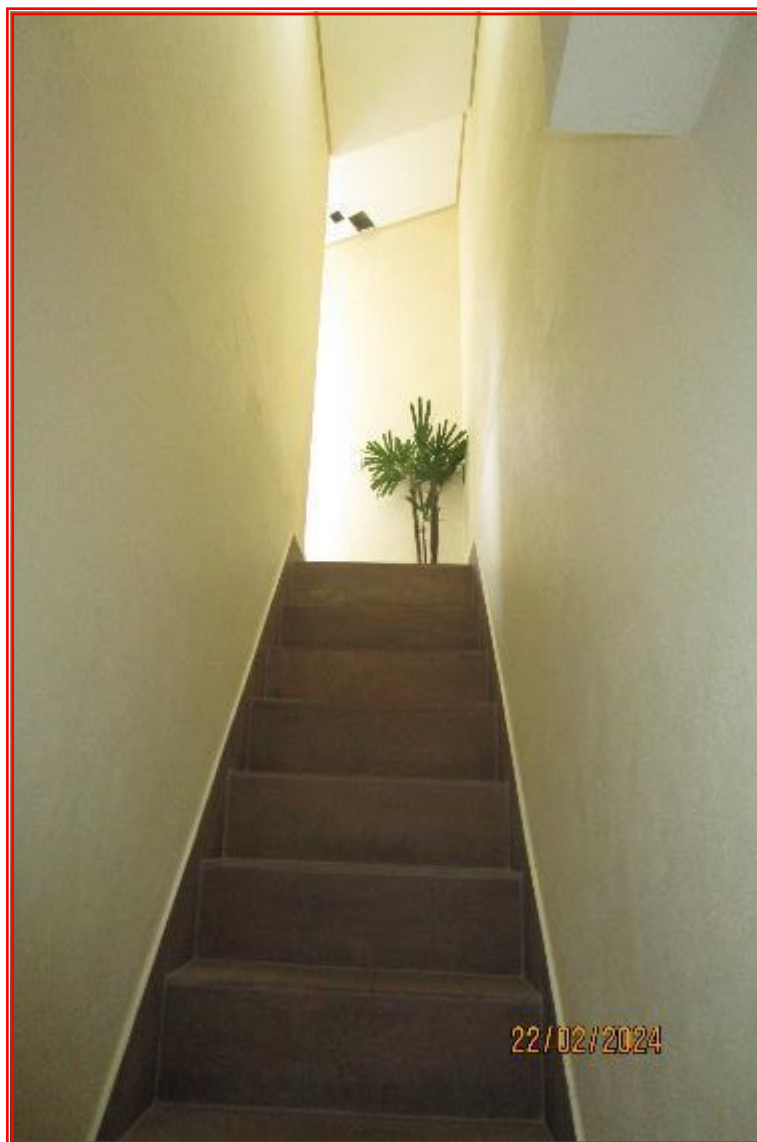
Foto n° 26: Vista parcial da escada de acesso aos pavimentos superiores (1º e 2º andar).
