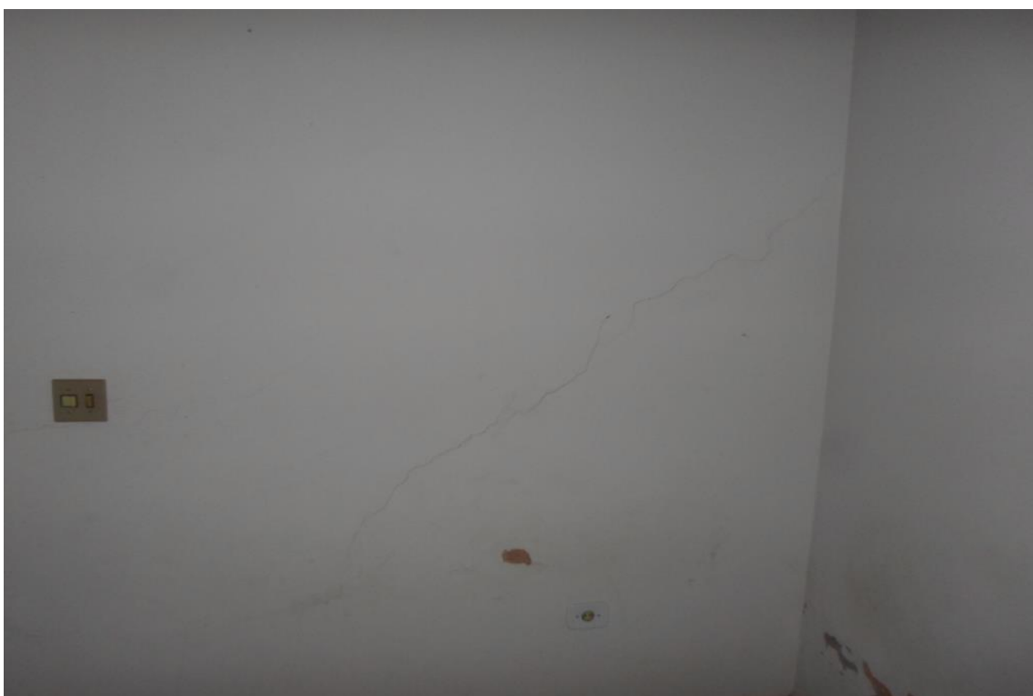
FOTOS 24 E 25 – Anexo fotográfico destinado fissuras de ordem estrutural observadas na referida edificação.
