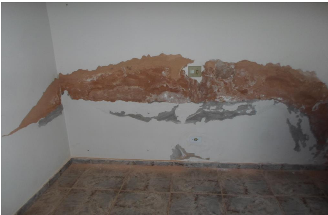
FOTOS 17, 18 E 19 – Anexo fotográfico destinado a mostrar algumas das paredes internas da edificação com problemas na argamassa de revestimento (reboco soltando/desagregando).
