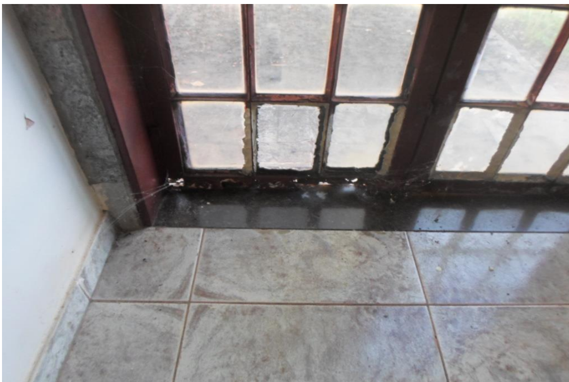
FOTO 20 – Anexo fotográfico destinado a mostrar um das portas metálicas da edificação com o perfil metálico totalmente corroído.
