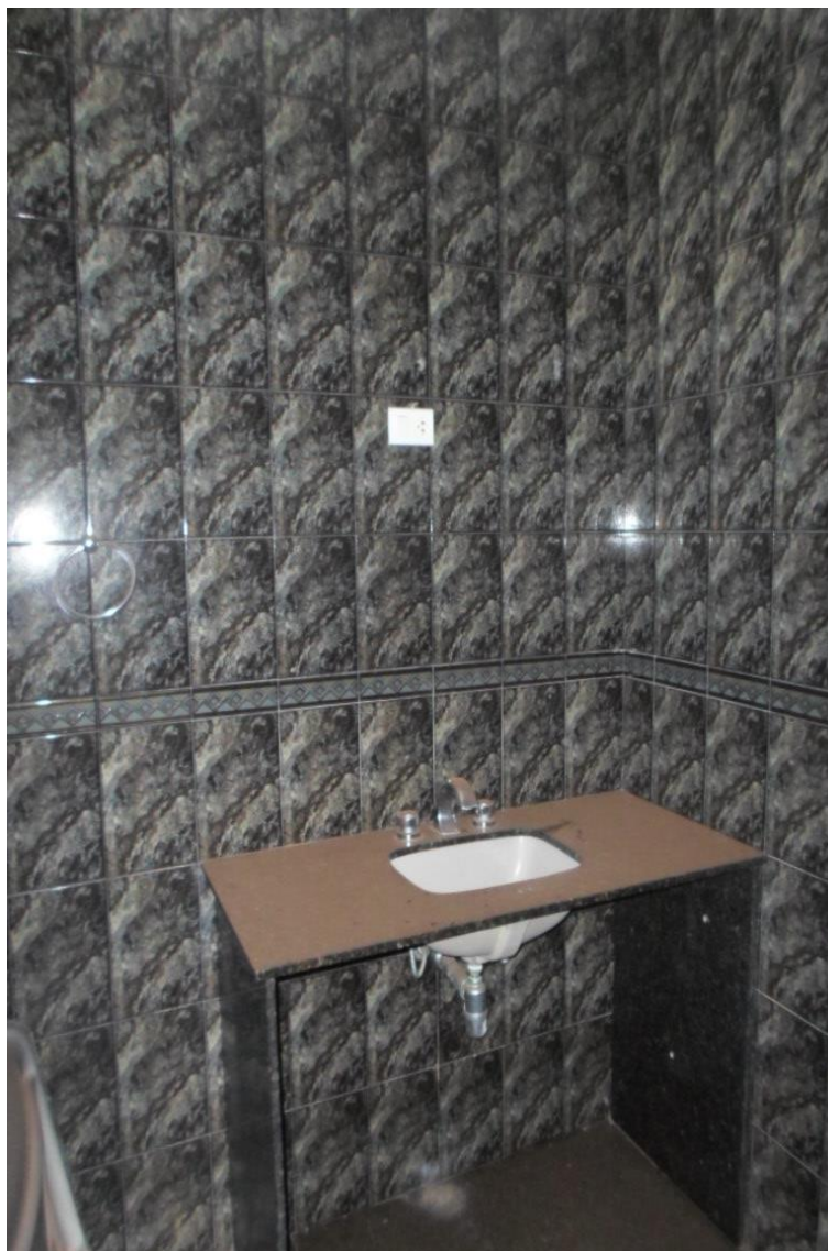
FOTO 21 – Anexo fotográfico destinado a mostrar dos banheiros da referida edificação, podendo-se observar o piso e o revestimento cerâmico.
