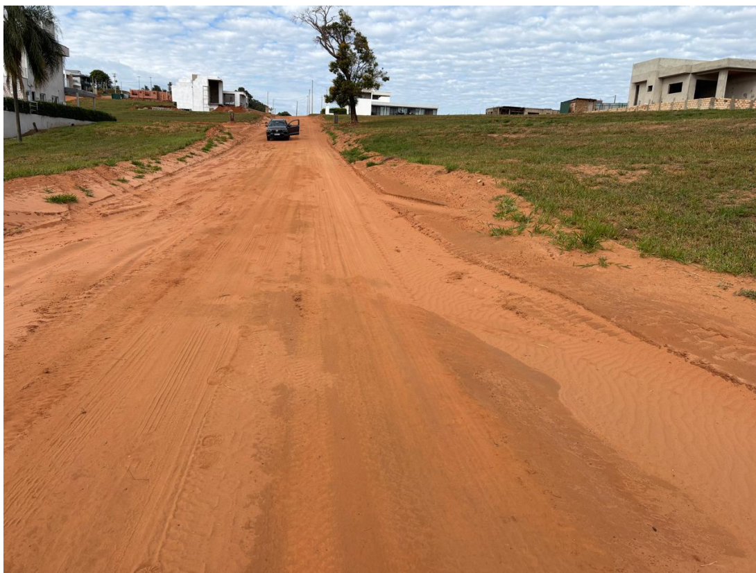
Imagem 9 – Rua 181 sem Pavimentação – Outra Vista (sentido contrário)
