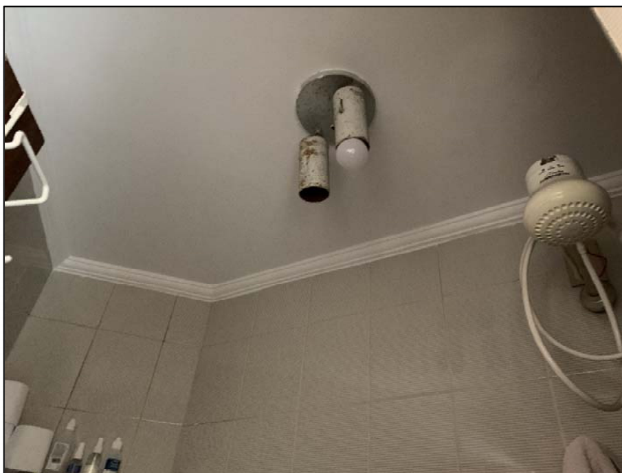
Foto 13. Detalhe do teto do banheiro de empregada.
