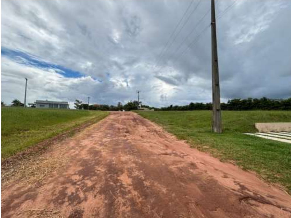
Imagem 9 – Via sem Pavimentação
