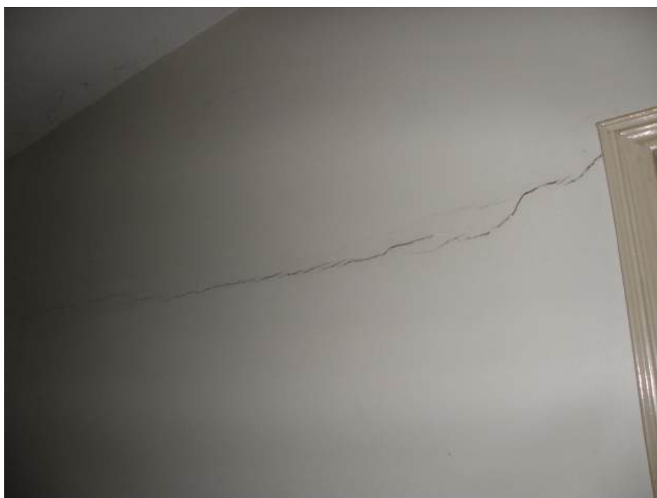
Foto: rachadura sem risco estrutural.
