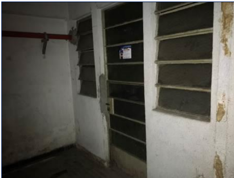
FOTO 20: VISTA DA SALA DA CASA DE MÁQUINA.
